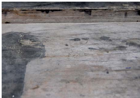
Kuva 48. Maaliroiskeita ja -valumia arkunaluslaudoissa ja sivupuussa (Nyrkkö 2009).
