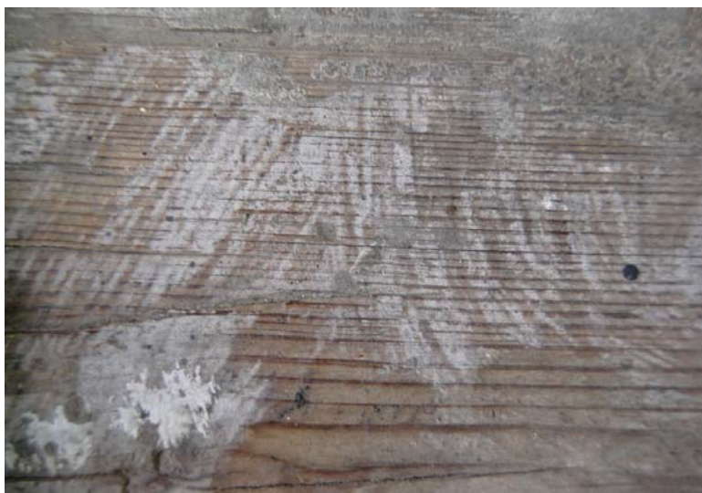
Kuva 51. Arkunaluslautojen epätasaista liimamaalipintaa (Nyrkkö 2009).
