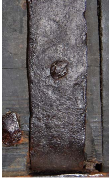
Kuva 46. Yksityiskohta raudoituksesta käsittelyn jälkeen (Nyrkkö 2010).
