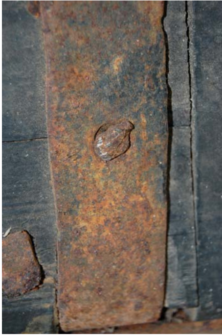
Kuva 45. Yksityiskohta raudoituksesta ennen puhdistusta (Nyrkkö 2010).
