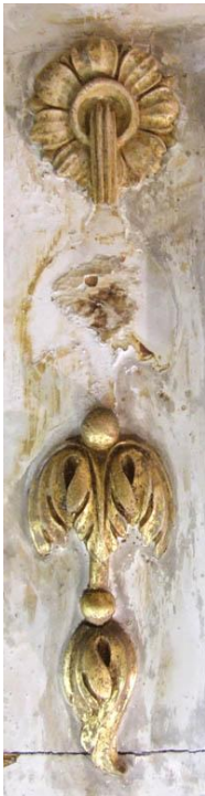
3) Vasemman kasviköynnöksen toiseksi ylin ornamentti puuttuu.
