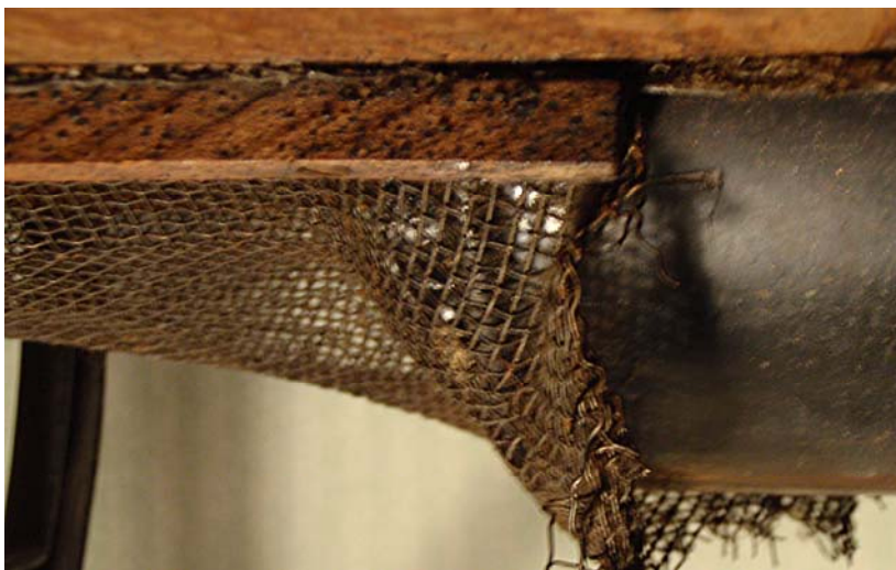
Kuva 20. Suojaverkon purkaantuneet rautalangat
