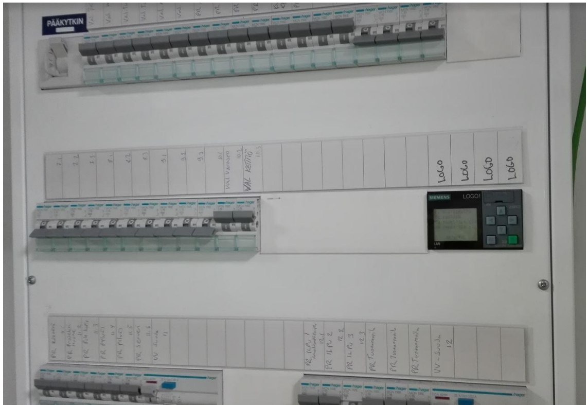
Kuva 14 Logiikan asennus ryhmäkeskuksessa.
