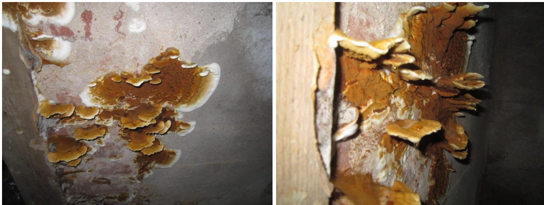
Kuva 18. Lattiasienen itiöemiä vauriokohteesta
