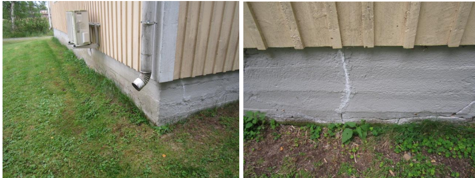
Kuva 14. Sadevedet laskevat sokkelien viereen. Sokkeleissa halkeamia. Tuuletusreikien määrä vähäinen sokkeleissa.
