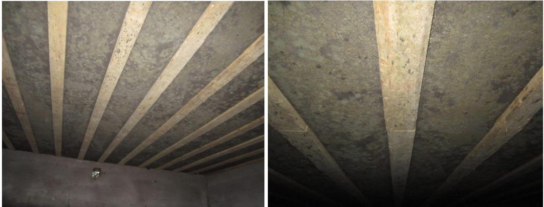
Kuva 6. Vuonna 2016 asennetut aluslaudat+tl-levyt vuonna 2017, mikrobivaurioituneet kauttaaltaan
