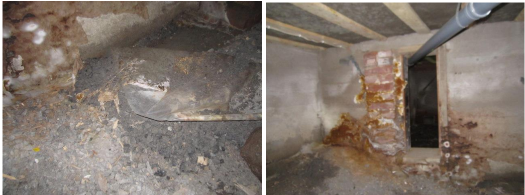
Kuva 16. Maapohjassa muovikalvo, jonka alapinta rihmastoinen. Muovikalvon alta rihmasto on kasvanut perusmuuriin kiinni ja noussut siinä ylöspäin.
