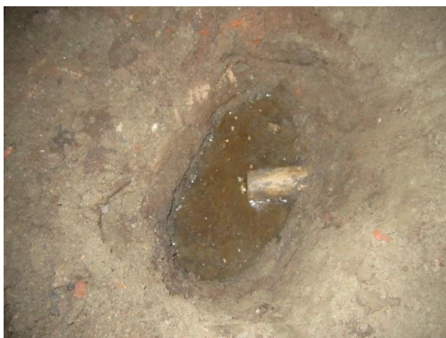
Kuva 13. Putkesta ohjautuu vettä ryömintätilan maamassoihin
