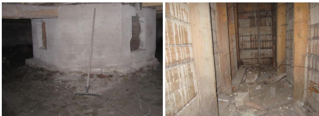
Kuva 17. Keskellä ryömintätilaa 3 osastoa, jotka toimivat ns. muurinpohjina. Osastojen sisällä rakennusaikaiset muottilaudat paikoillaan, jotka ovat yhteydessä märkään maaperään. Laidoitukset lahoja ja rihmastoisia.
