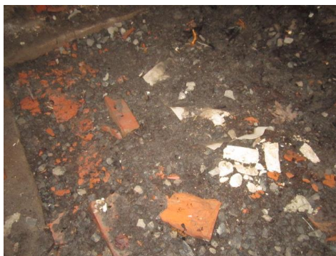
Kuva 15. Maapohja ryömintätilassa silminnähden vesimärkää, ilma seisovaa heikosta tuuletuksesta johtuen
