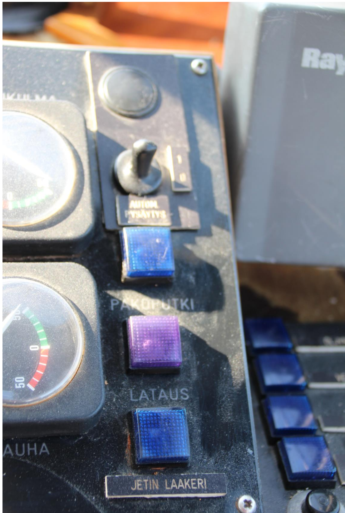
Kuva 13 Suojausautomaatiikan ohituskytkin partiovene PV-323 ohjaamossa.
