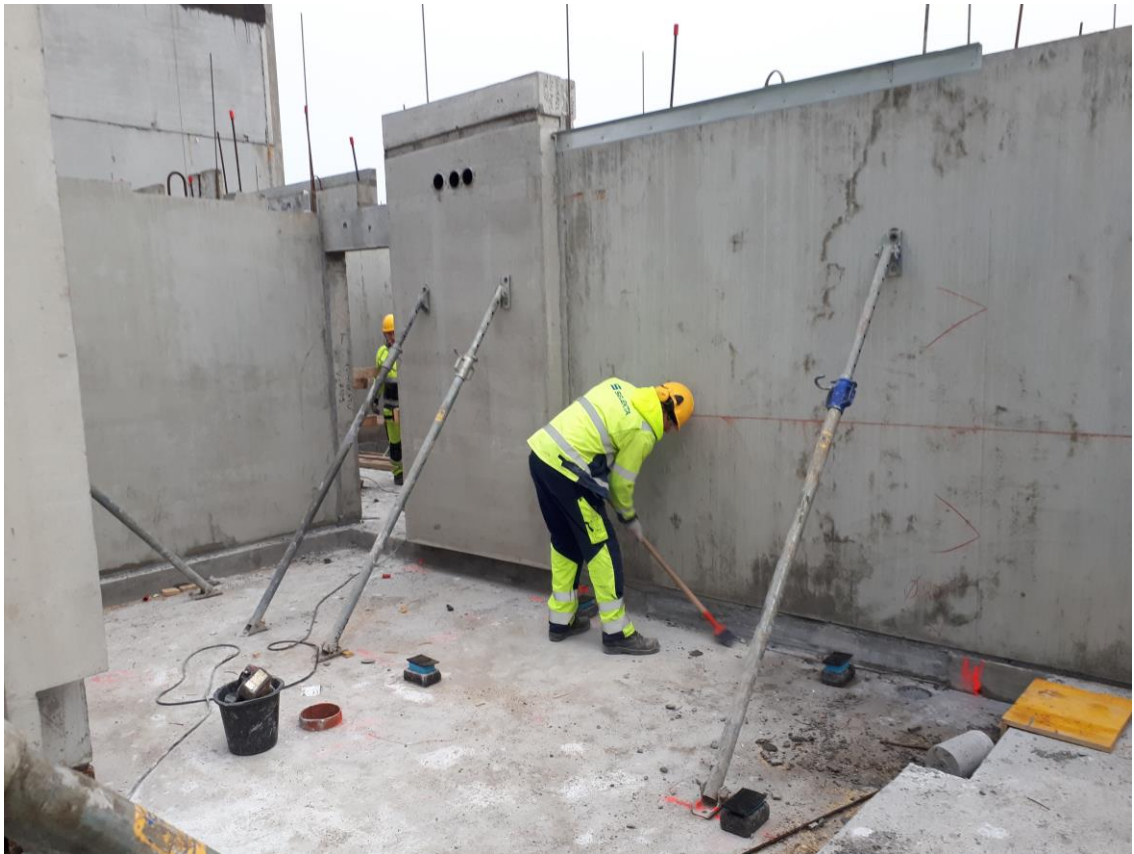
Kuva 10. Asennuksen esivalmistelu. Huomaa L-pelti seuraavan holvin tukkolaudoituksena. Kylpyhuone-elementin kohdalla oleva tönäri on vielä irrottamatta.
