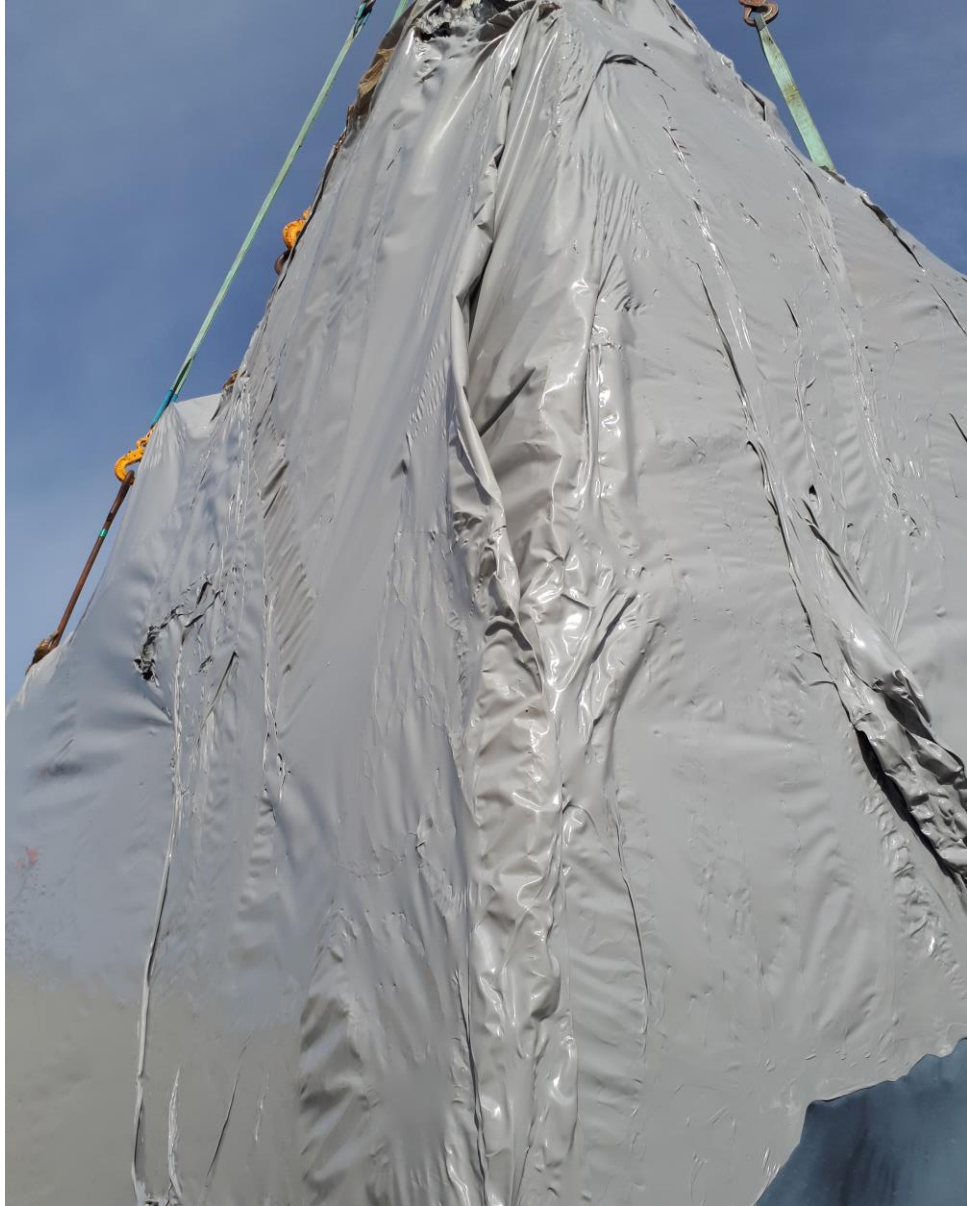
Kuva 16. Elementin kulmassa on liikaa muovikerroksia. Hankala laittaa vesivaaka kulmaan.
