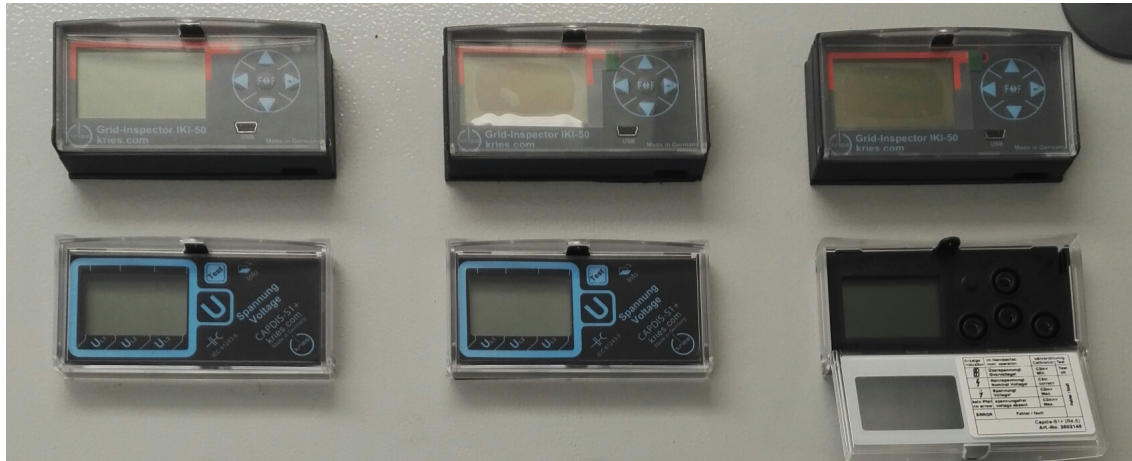
Kuva 7. Kriesin IKI -vikaindikaattoreita ja CAPDIS -jänniteilmaisimia laitakaapin kanteen kasatuna. Oikealla jänniteilmaisimessa vaiheistamisen mahdollistavat kosketussuojatut liittimet näkyvillä.
