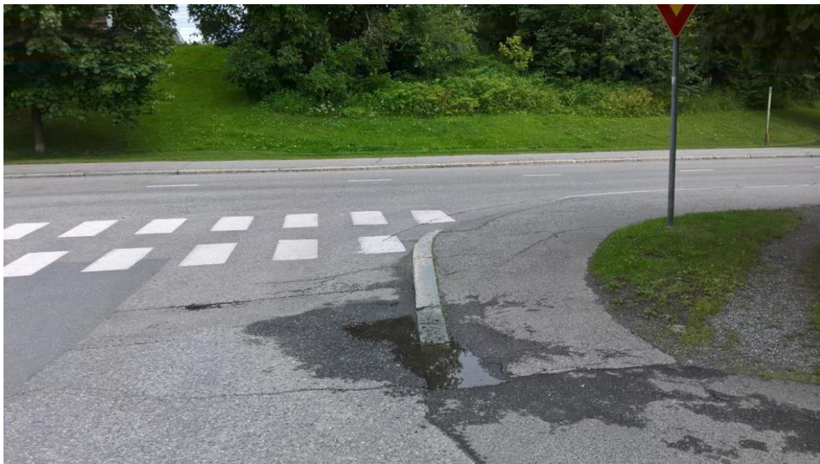
Kuva 9. Graniittireunakivi on nostettava lätäköstä ylös ennen kuin kyseisen lammikon kohdan voi paikata asfaltilla. (Kosunen 2017–7–27)
