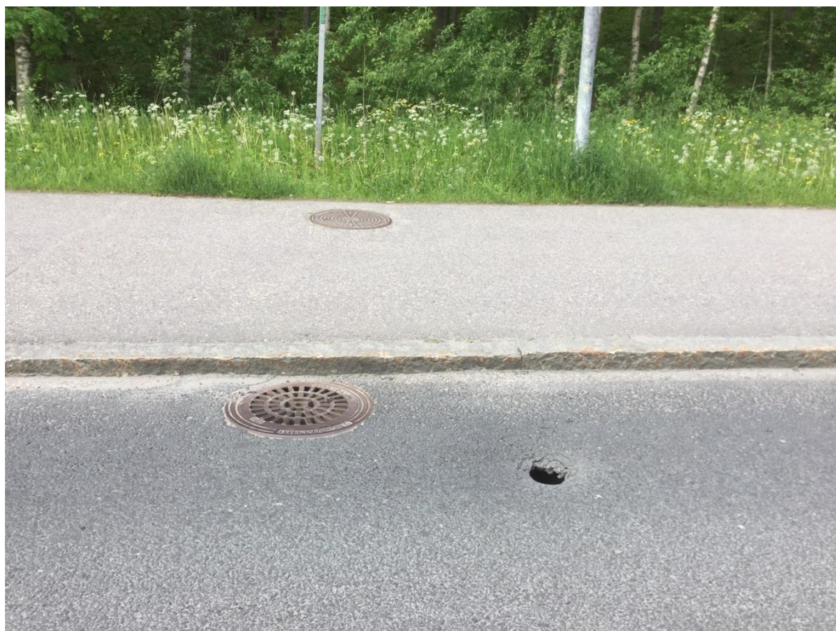
Kuva 1. Ajouradalle syntynyt korjausta vaativa reikä (Rissanen 2016-6-22)
