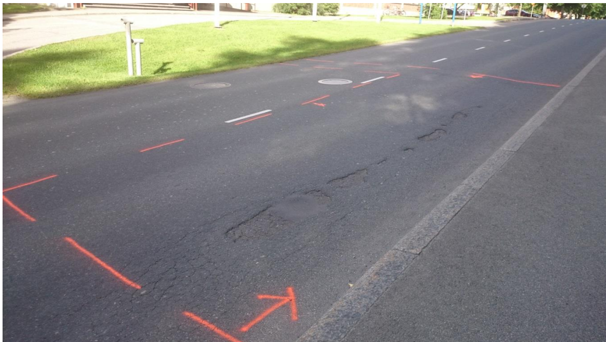
Kuva 7. Suurempaa korjaustarvetta vaativassa kohteessa päällysteen tuleva sauma on merkitty ajoradan keskiharjanteelle (Kosunen 2016-8-9)
