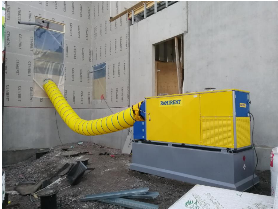
Kuva 14. Ramirentin 195 kW lämmityskontti.
