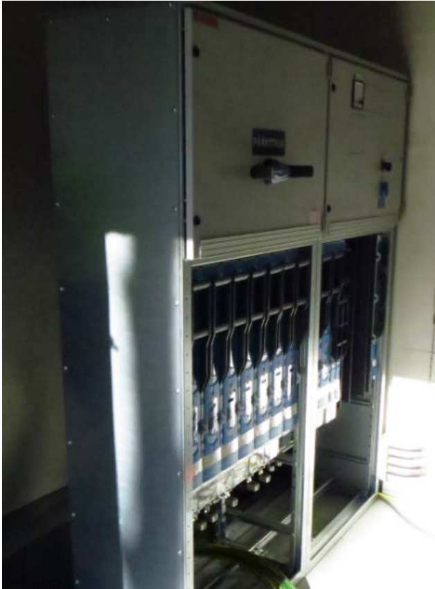
KUVA 16 Uusi pienjännitekeskus paikoillaan
