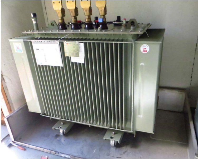
KUVA 18 Uusi muuntaja öljykaukalonsa kanssa
