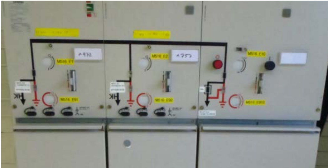
KUVA 33 Valmiin keskijännitekojeiston merkinnät
