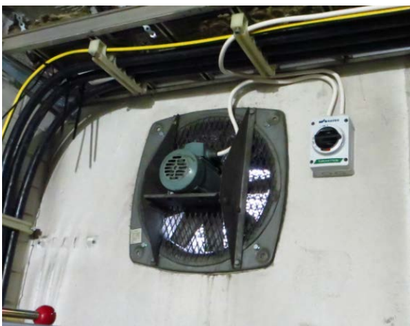
KUVA 26 Ilmanvaihtokone ja turvakytkin
