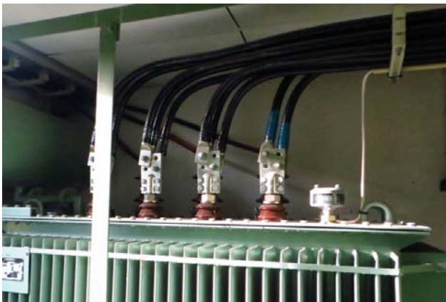
KUVA 8 Muuntajan vanhat välikaapelit
