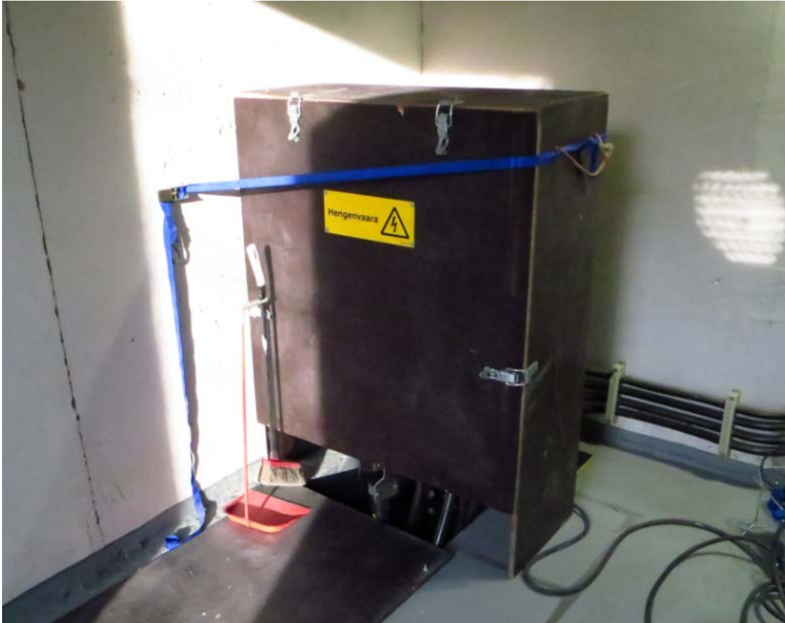
KUVA 13 Suojaus jännitteisille kaapeleille
