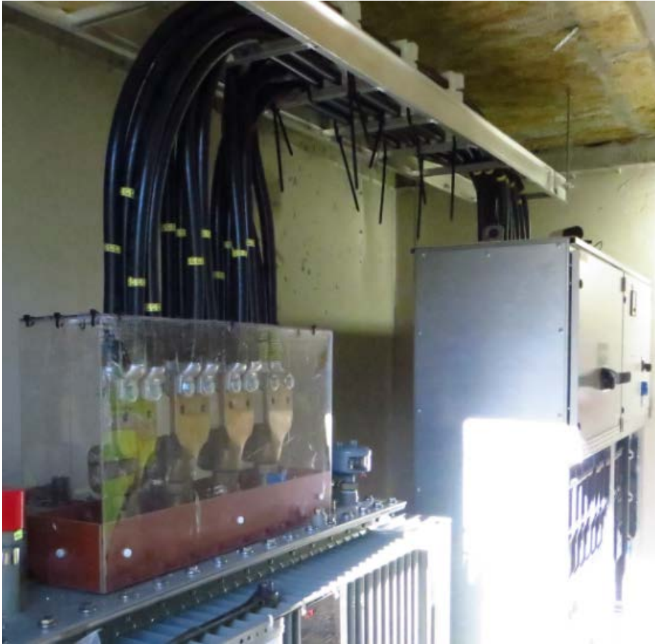
KUVA 24 Muuntajan pienjännitenapojen kosketussuojaus
