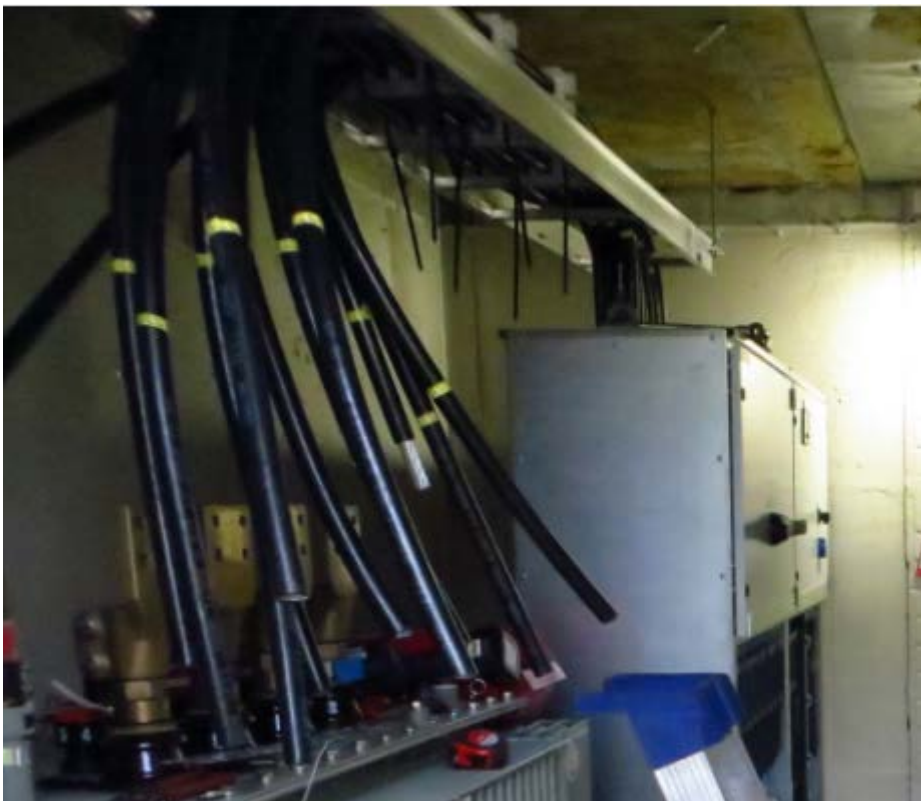
KUVA 20 Välikaapelit välillä muuntaja-pienjännitekeskus
