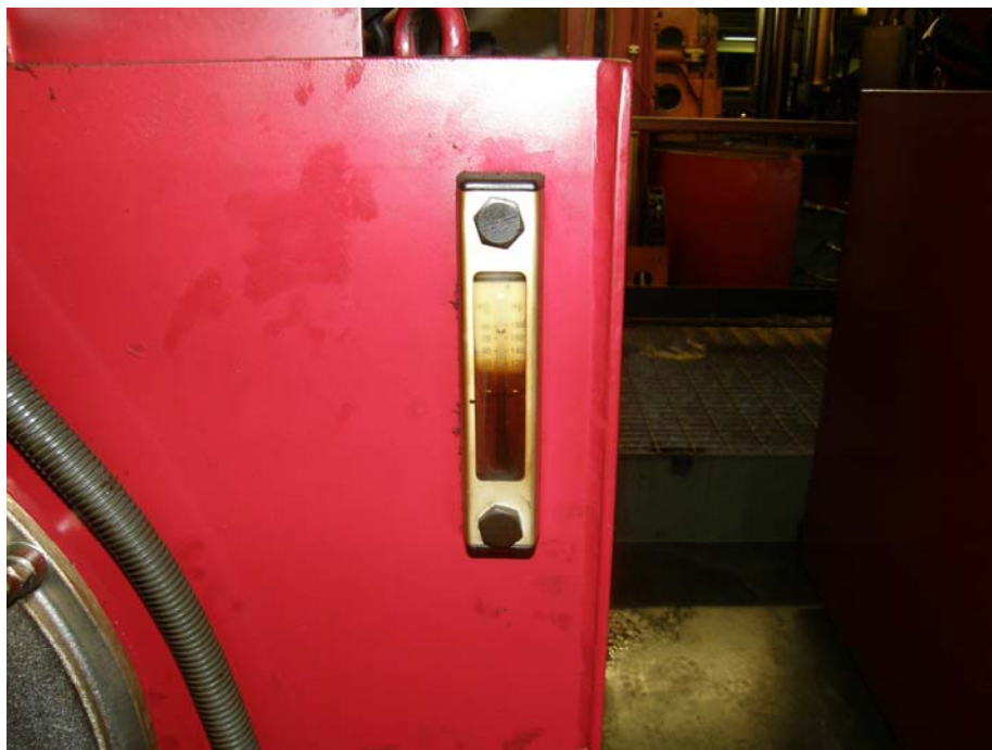
Kuva 9. Öljysäiliön pinnankorkeus- ja lämpötilamittari
