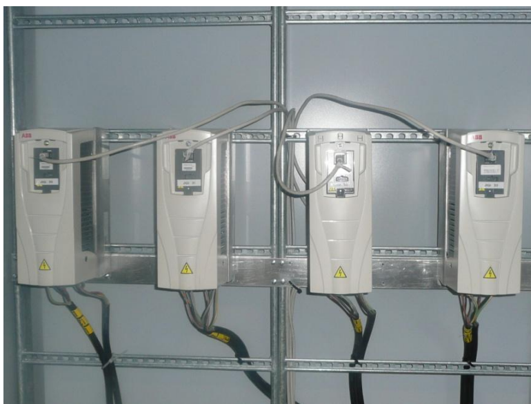
Kuva 5.10. Testattavat taajuusmuuttajat 7,5 kW testikammiossa.
