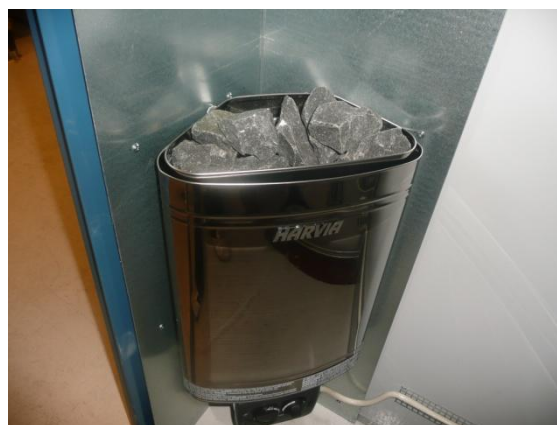
Kuva 5.8. Testikammin lämmityksestä vastaava kiuas.
