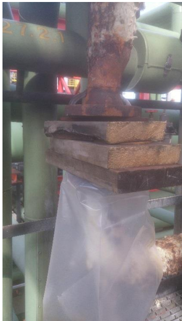
KUVA 2. Tuettu ylempi linja. Ylimmäisenä sokea laippaa vasten ilman tiivistettä
