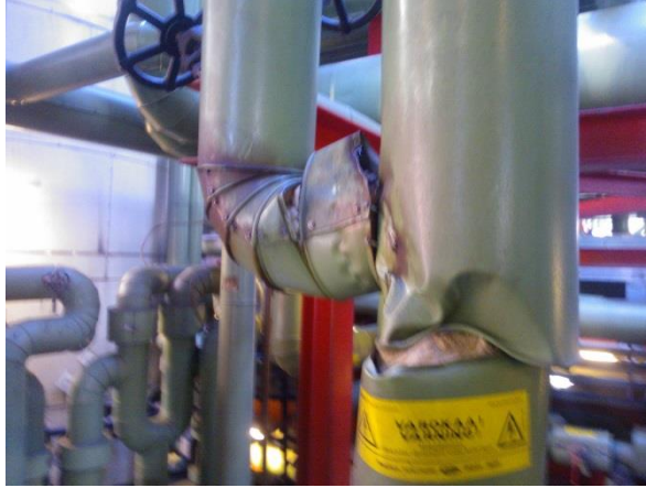
KUVA 1. Taljaus tehty väärästä paikasta
