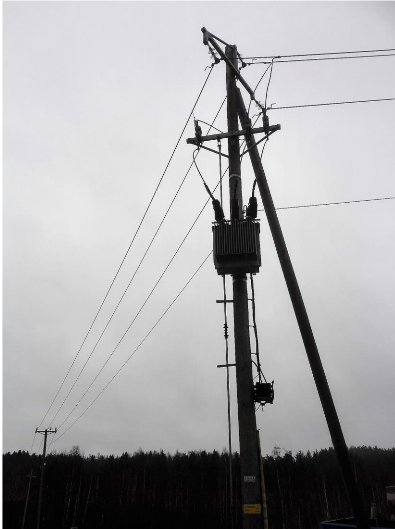
Kuva 4. 20000/400 V:n muuntosuhteella toimiva 100 kVA:n pylväsmuuntaja Kirkkonummella.
