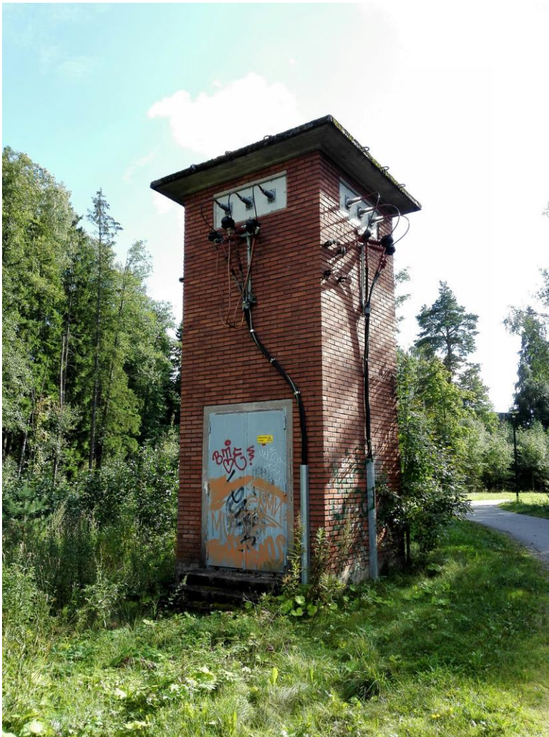
Kuva 13. Espoossa sijaitseva vanhanmallinen muuntamo, jonka syöttö on tullut alun perin ilmajohdoista. Muuntamorakennuksessa on havaittavissa graffiteja ja töherryksiä.
