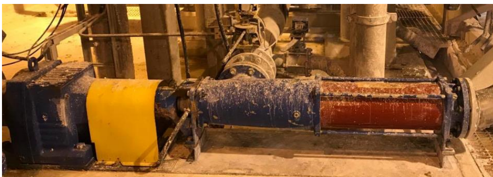
Kuva 31 PK8 Optisizer aseman pumppu
