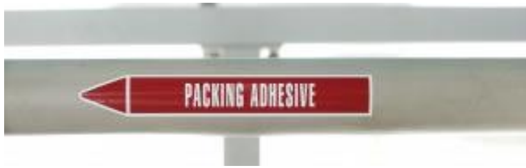
Kuva 1. putkiston sisällön ja virtaussuunnan merkintätapa. (Exxi, putkistomerkinnot)
