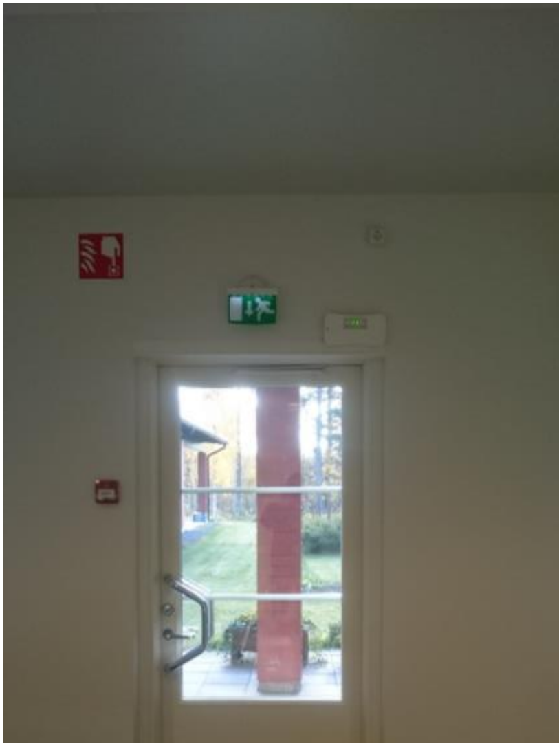
Kuva 2. Turhaksi jäänyt pistorasia ja muovikourulla jälkiasennettu ovirasian johdotus
