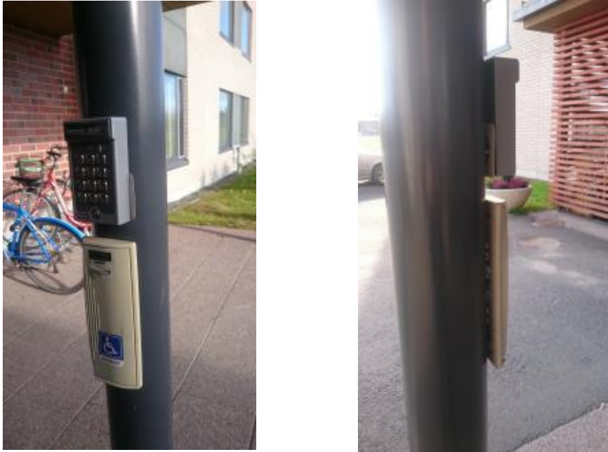
Kuva 6. Pyöreäprofiiliseen kannatintolppaan asennettuja oven käyttölaitteita
