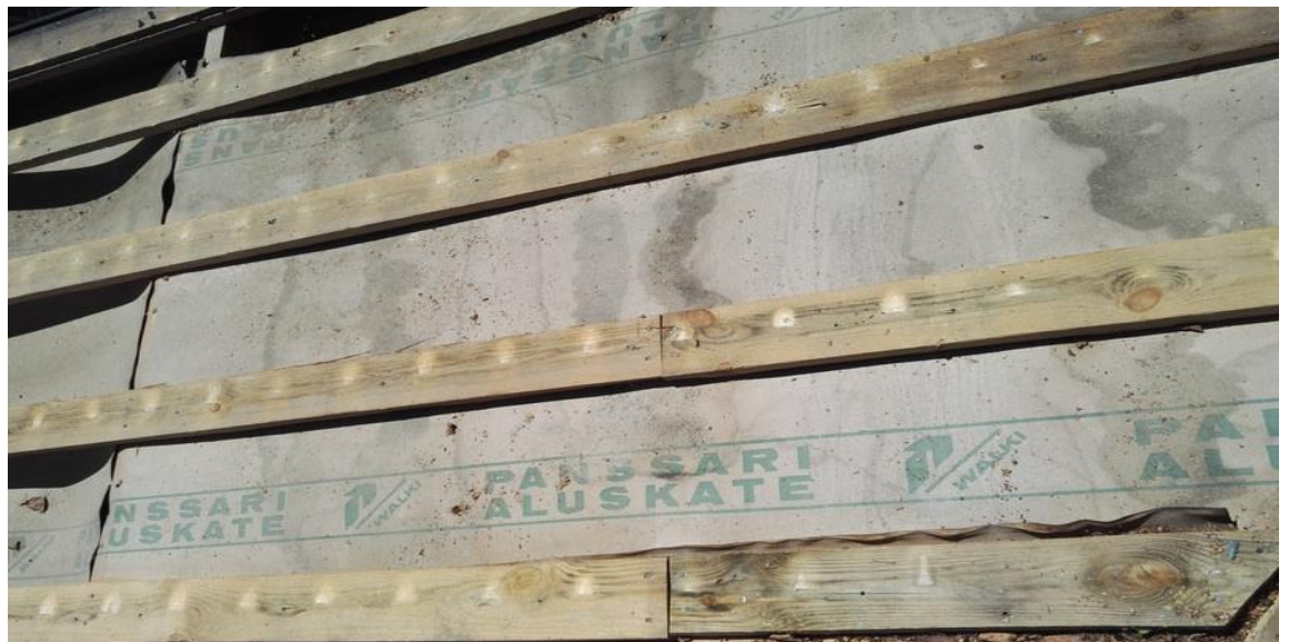
Kuva 5. Aluskatteesta näkyi tummia alueita, johon vesi oli päässyt. (Jokinen 2017-6)
