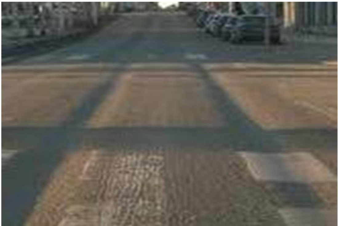
Kuva 5. Kulumisesta johtuva urautuminen. ( Kuva: Iisalmen Sanomat)
