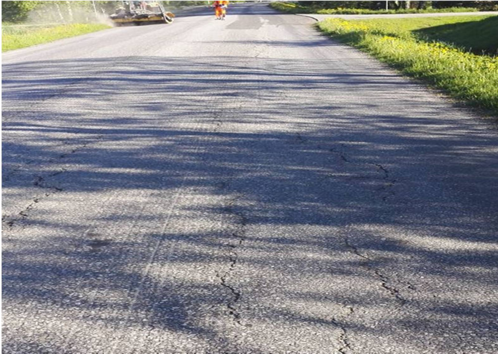
Kuva 1. Pituussuuntaisia halkeamia kadun päällysteessä.
