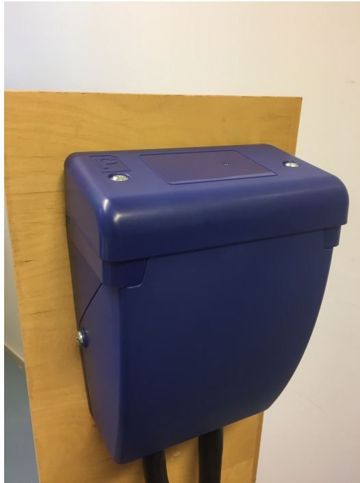
Kuva 9. Parkkisähkön pikaliitin. Pikaliittimen hattu poistetaan, kun siihen liitetään latauslaite.
