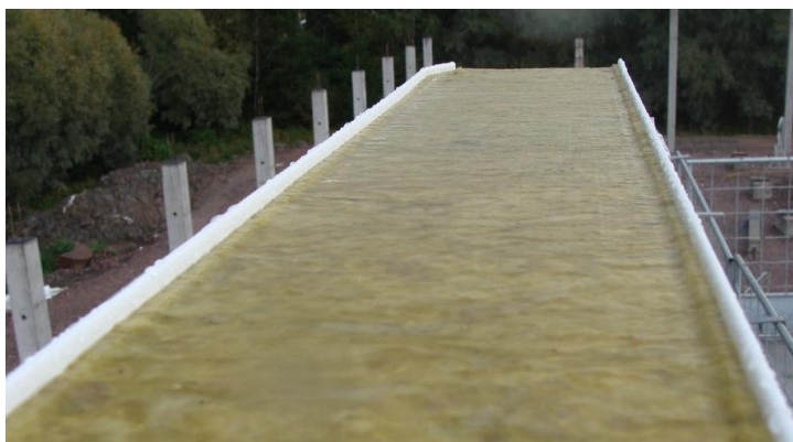
Kuva 2. Elementtien paljaat villapinnat eivät saa kastua vaan ne tulee suojata.
