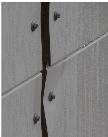
Kuva 5. Ylikiristetyistä kiinnikkeistä johtuva painauma.
