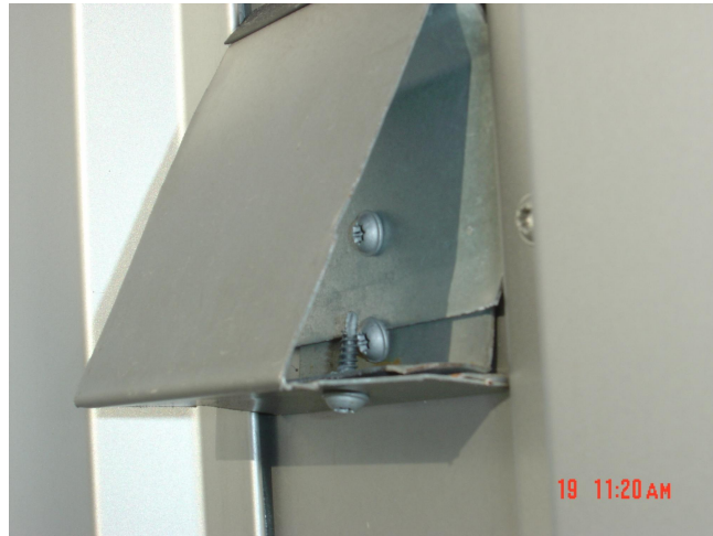
Kuva 20. Auki leikattu koristelistat. Sisään päässyt vesi ei pääse poistumaan minnekään, jolloin se tunkeutuu tiivistämättömistä ruuvirei'istä elementtien eristeisiin.
