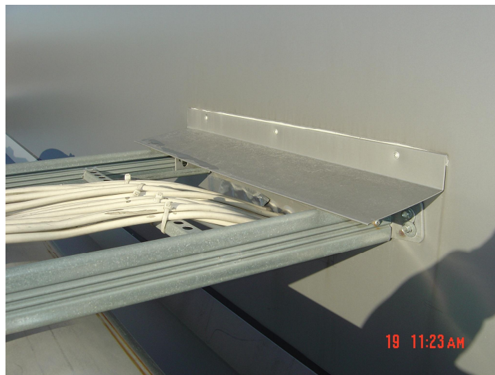
Kuva 35. Puutteellisesti eristetyt läpiviennit ja viettävät johdot johtavat veden eristeisiin, eikä johtojen päälle tehty peltiviritys auta asiaa.
