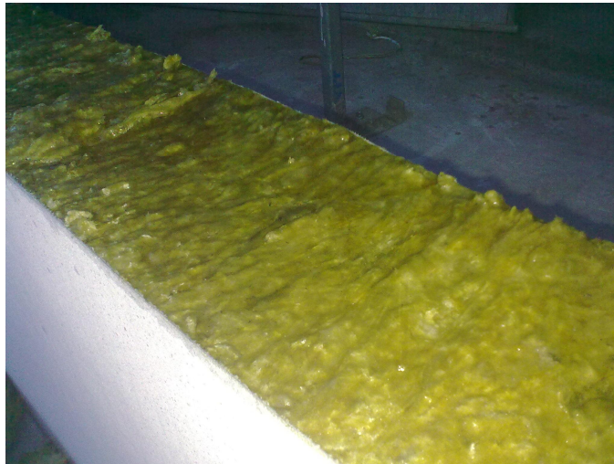
Kuva 24. Rakennusaikainen suojaus on jätetty tekemättä ja IV-konehuoneessa sijaitseva muotoon leikattu elementti on kastunut viikonlopun aikana todennäköisesti läpimäräksi.
