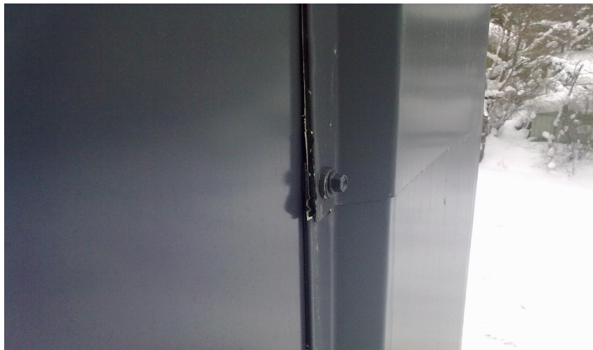
Kuva 28. Saumapellit kiinnitetty virheellisesti toisiinsa kiinni.
