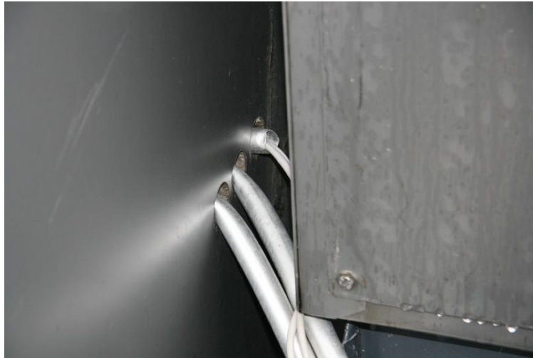
Kuva 36. Läpiviennit jätetty sisäpuolelta tiivistämättä.
