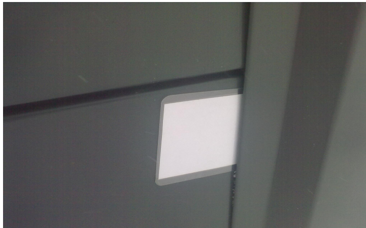
Kuva 27. Saumapeltien tiiviste on irronnut elementistä lämpöliikkeestä johtuen.
