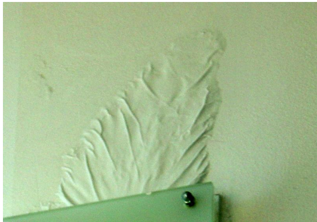
Kuva 19. Tasoite ja maalivaurio toimistorakennuksen aulassa, mikä johtuu pelti-villa-pelti-elementtien saumojen vuodosta katon IV-konehuoneessa.
