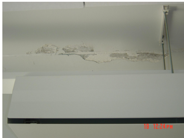
Kuva 23. Rakennuksen katolla sijaitseva peltielementtirakenteiden IV-konehuoneen villat ovat kastuneet ja vesi on valunut elementin eristeiden ja betonin kautta alakerran toimistotilaan.
