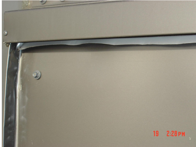
Kuva 38. Räystään myrskypelti on tuotu liian alas. Myrskypelti asennettuna liian alas pikemminkin edesauttaa lumen ja veden kulkua eristekerrokseen.
