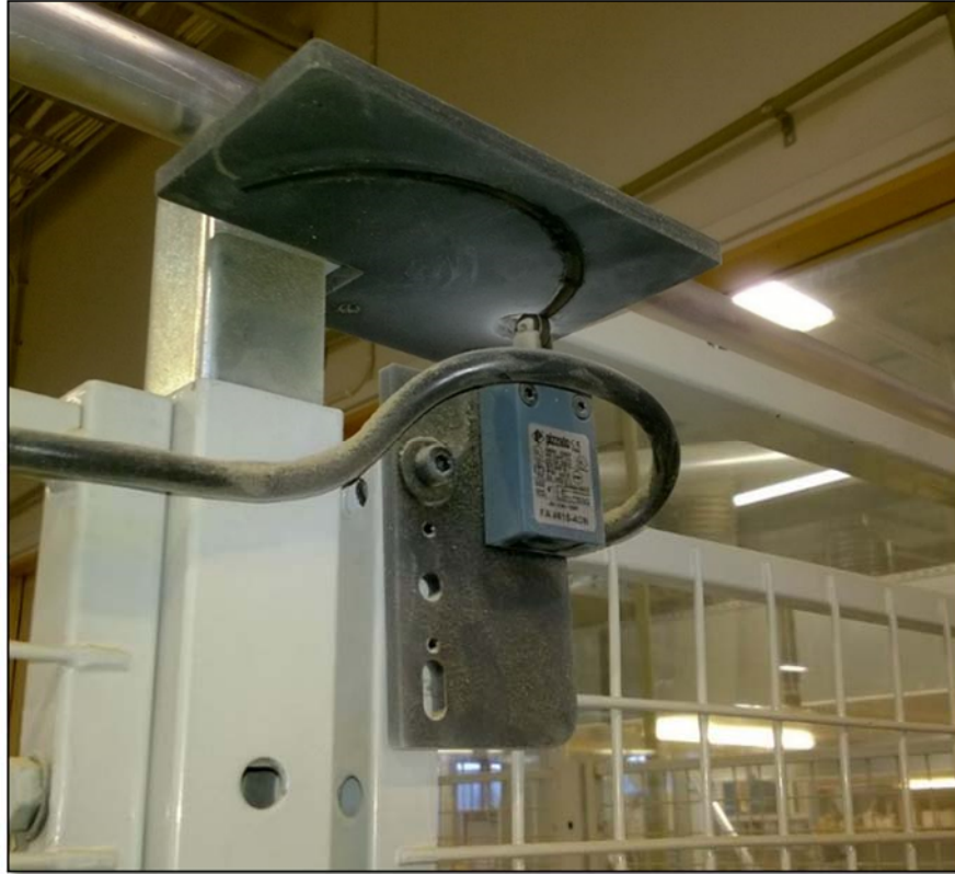
Kuva 36. CNC koneen huoltotilaan johtavan oven rajakatkaisija. (kuva: JIJ 2017)
