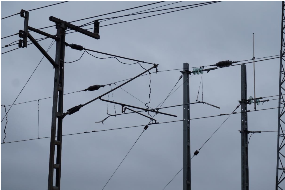
Kuva 8. Erotusjakso Lamminpään syöttöaseman läheisyydessä.
