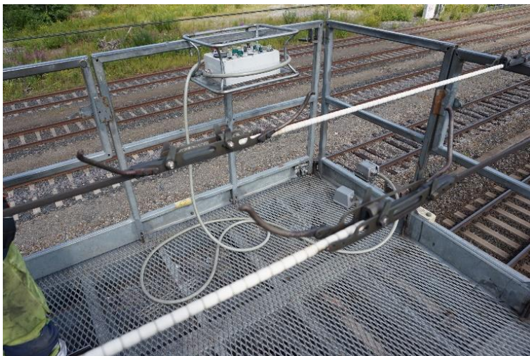
Kuva 10. Ryhmityseristimellä kohtaavat kytkentäryhmät, valokaaren sieppaussarvet sekä valkoisena näkyvät eristävät osuudet.
