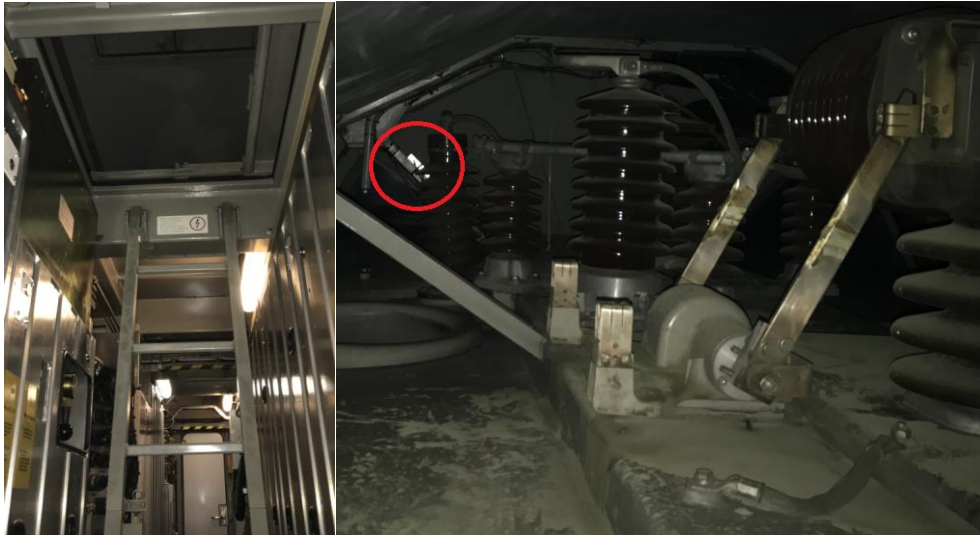
Kuva 23. RSRU sijaitsee fyysisesti veturin ylä-laitetilassa.
