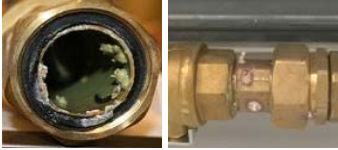
Kuva 4. Putkinäytteen messinkiliittimen sisäpinnalla näkyi saostumaa vuoden käytön jälkeen (kuva vasemmalla). Kolmen vuoden käytön jälkeen saostumaa näkyi liittimen ulkopinnalla (kuva oikealla).
