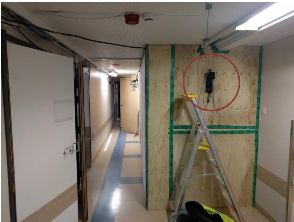
Kuva 2. Työmaan rajan osastoinnin välinen jatkuva paine-eromittaus
