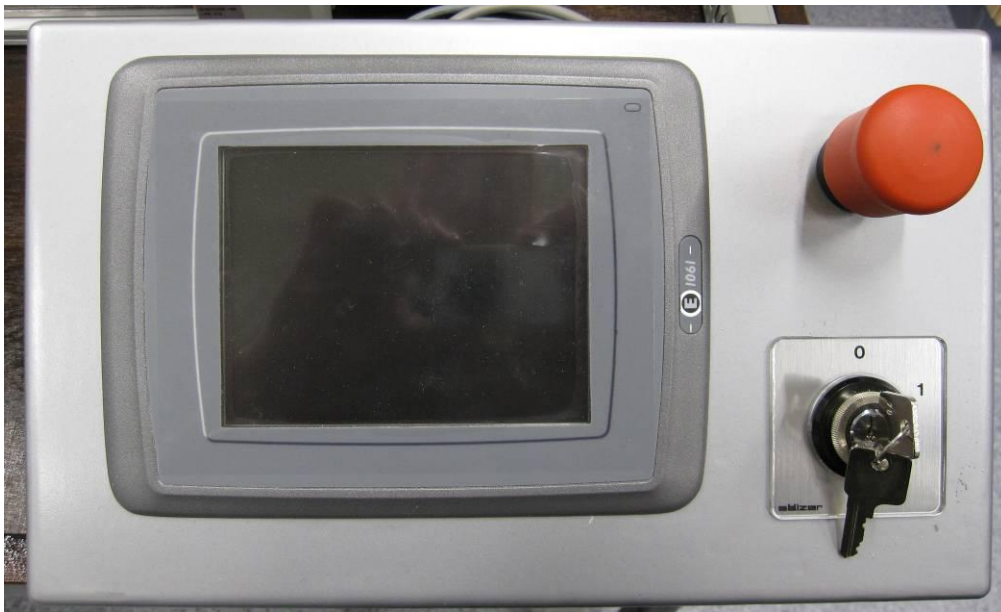
KUVIO 22. Operointipaneeli asennettuna ohjauspöytään
