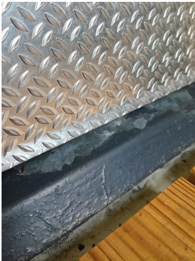
Kuva 5. Taustaseinän pellityksen maalipinnan vaurio.
