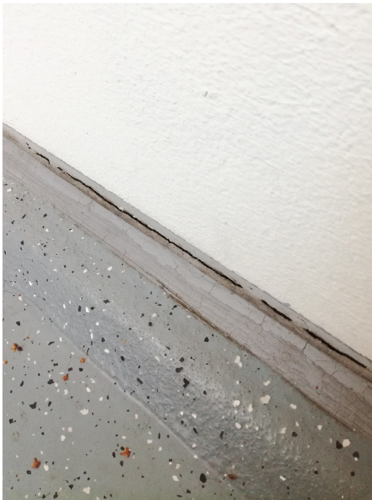
Kuva 13. Taustanseinän ja parvekelaatan välisen sauman kunto.
