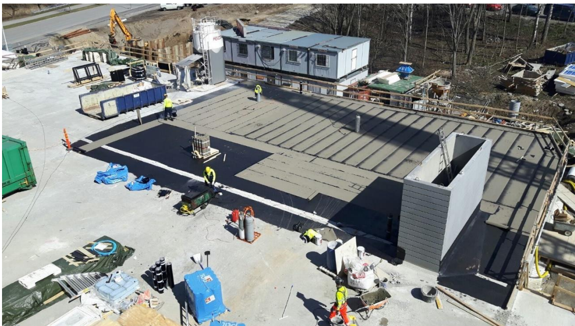
Kuva 4 Ensimmäisen lohkon vedeneristystyöt on aloitettu. Alimmaisena oleva musta liuos jätetään liikuntasauaman kohdalta pois, jotta huopa pääsee elämään.
