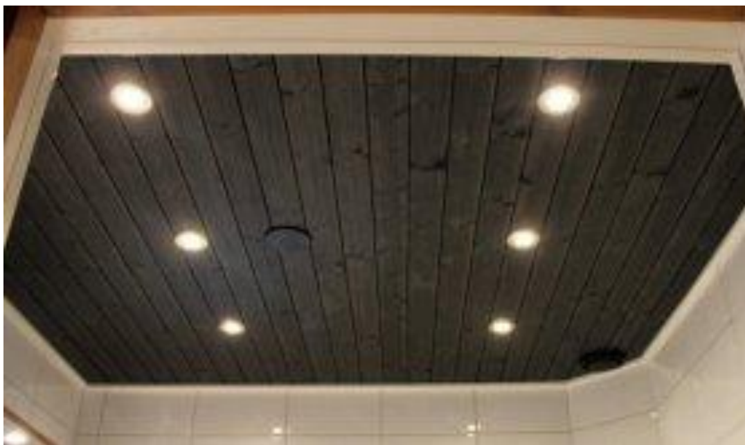
KUVA 13. Märkätilan paneelikatto (Kylpyhuoneen katto 2017).
