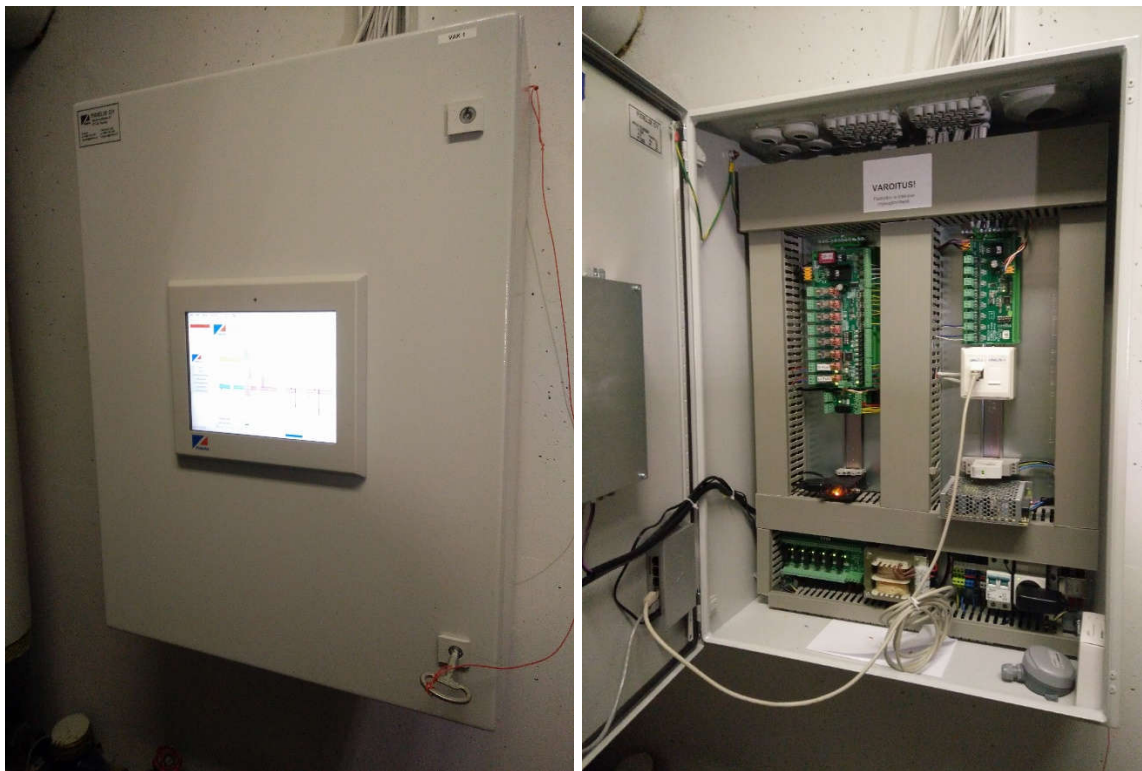
Kuva 7: VAK1 asennettuna ja kytkettynä (Jesse Miettinen 2016-9-8)
