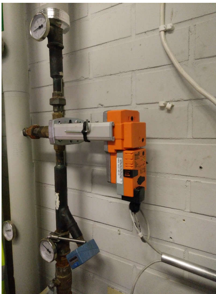
Kuva 16. Venttiilimoottori asennettuna ja kytkettynä (Jesse Miettinen 2016-8-11)
