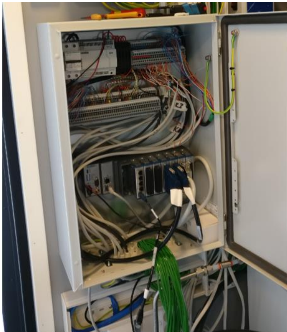
KUVA 6.6. Kytcentäkeskus virtasignaalia käyttävien laitteiden kytkemisen jälkeen (Miettinen 2017).
