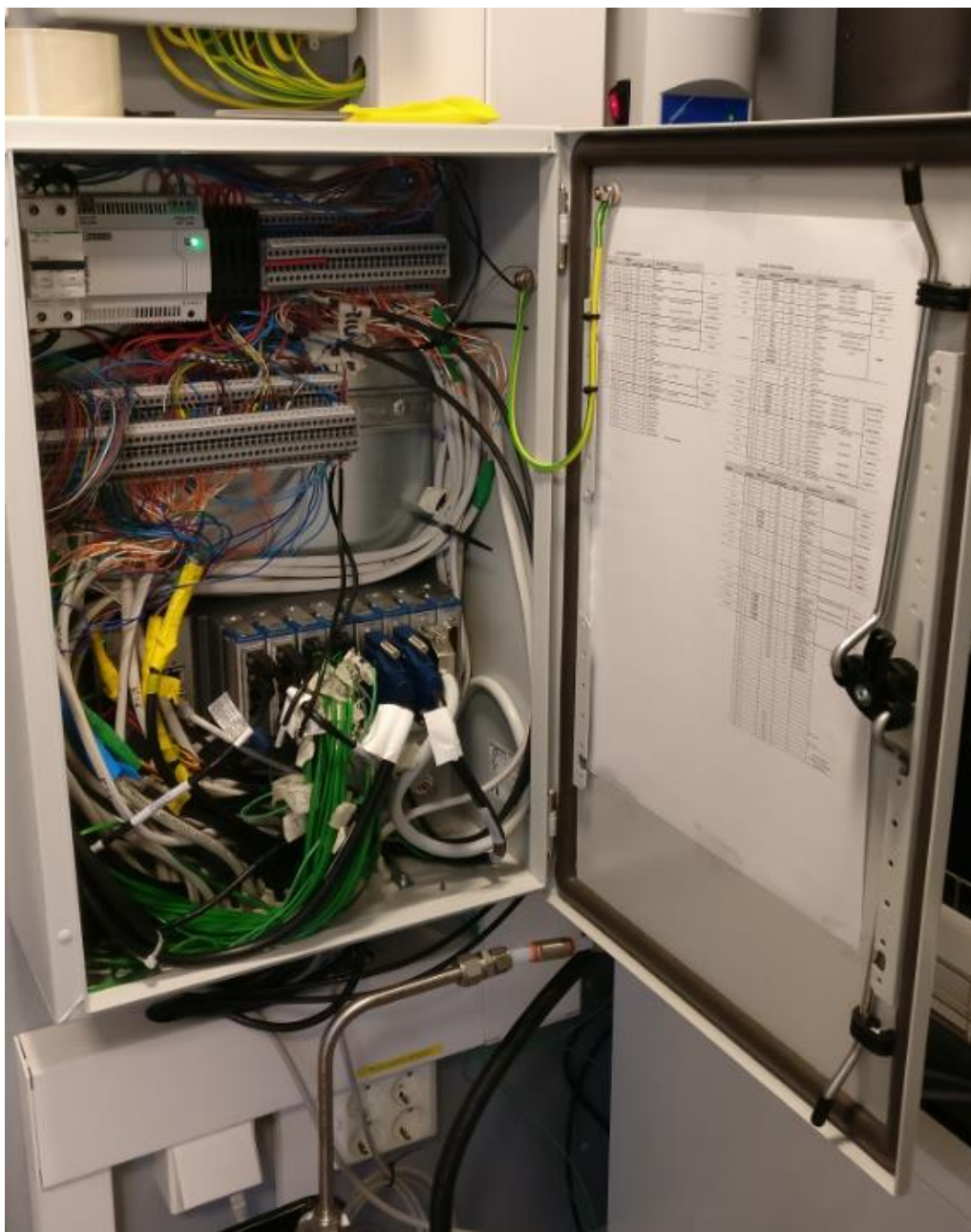
KUVA 6.8. Kytcentäkeskus loppujen kaapeleiden ja termoparien kytkemisen jälkeen. Etalometrin ja kaasuanalysoitsijoiden ethernet-kaapelit on kytketty myös cRIO-moduuleihin. Keskuksen oven sisäpuolelle on teipattu aiemmin esitellyt kytkentätaulukot. Tässä vaiheessa keskukselta puuttuu ainoastaan reititin, joka sijoittui alemman riviliitinpuolelle oikealle puolelle DIN-kiskoon. (Miettinen 2017.)
