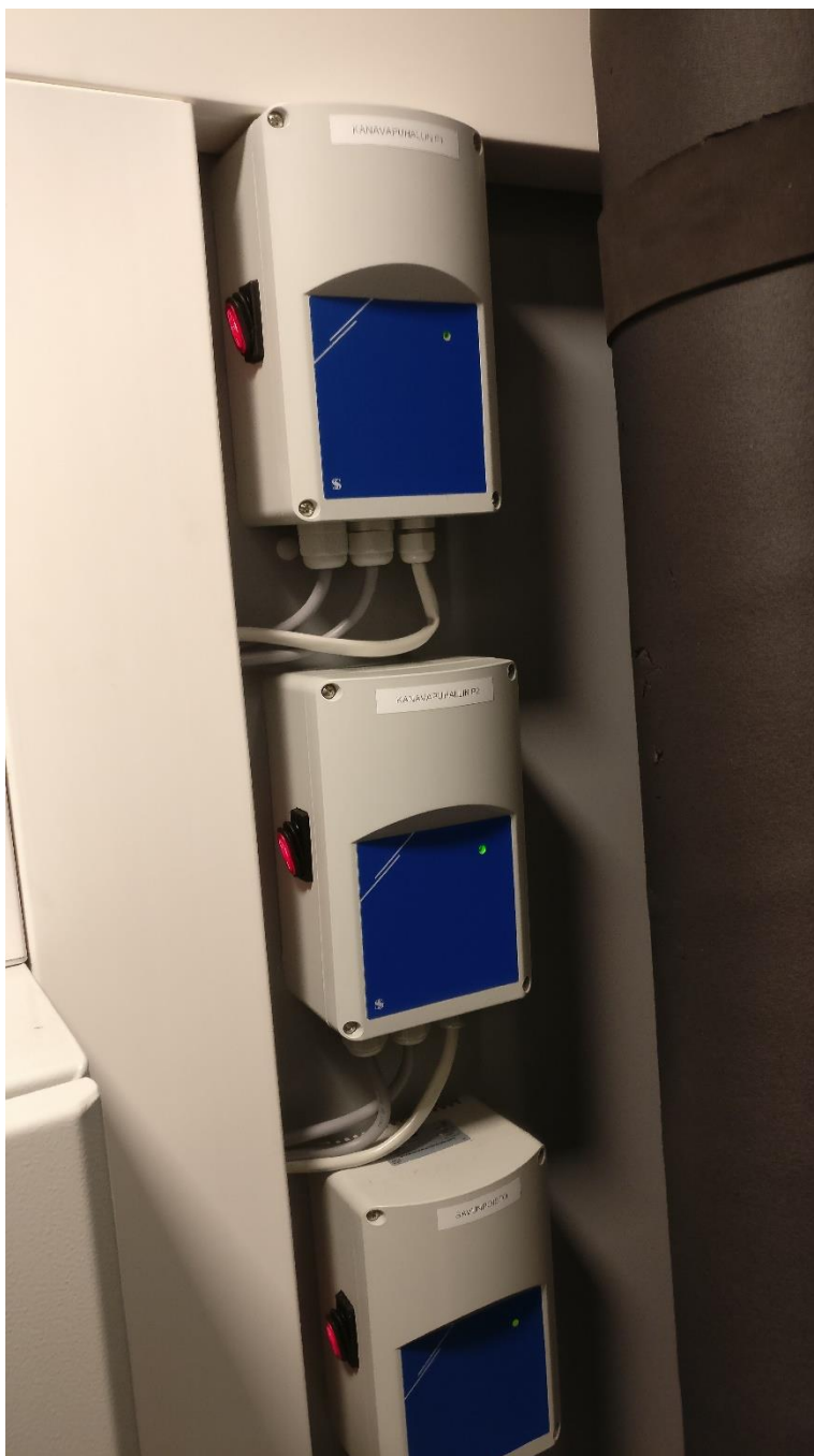
KUVA 5.9. Tyristorisäätimet kanavapuhaltimille (Miettinen 2017).
