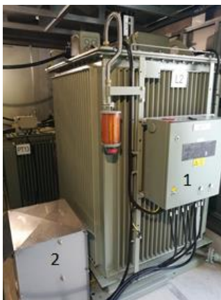
Kuva 12. Kompensointikuristin, Vaasan Purolan sähköasemalta. 1) kuristin 2) lisävastus.
