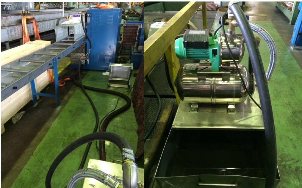
Kuva 8. Veden kierto ja Kuva 9. Veden puhtauden tarkastaminen (Heinonen)
