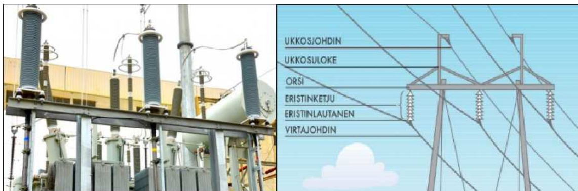
Kuva 10. Vasemmalla venttiilisuoja (Kuvannut: Janne Määttä) ja oikealla avojohtoverkossa käytettävä ukkosjohdin (Fingrid).
