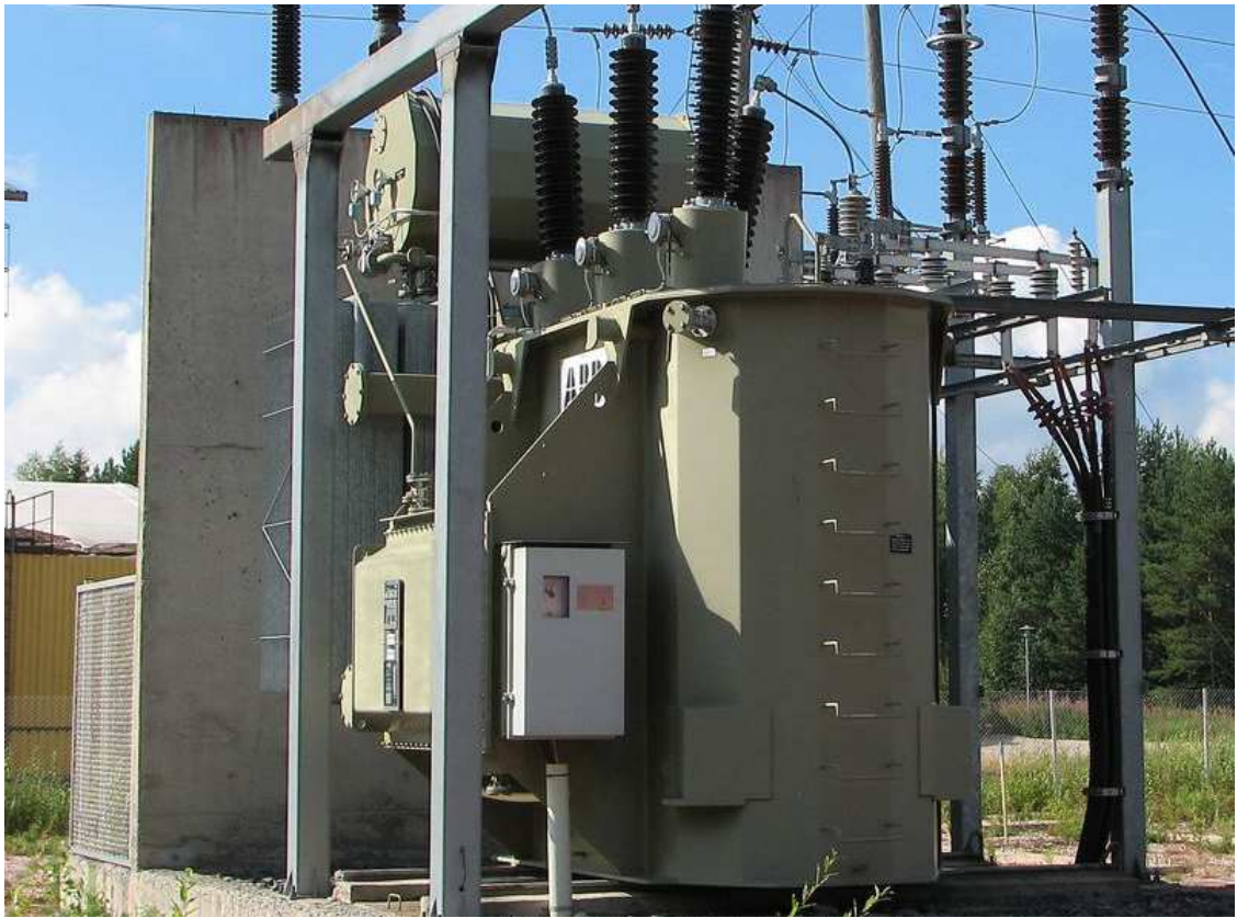
KUVA 11. 110/20kV 25MVA päämuuntaja. (Valokuvaaja Janne Määttä)
