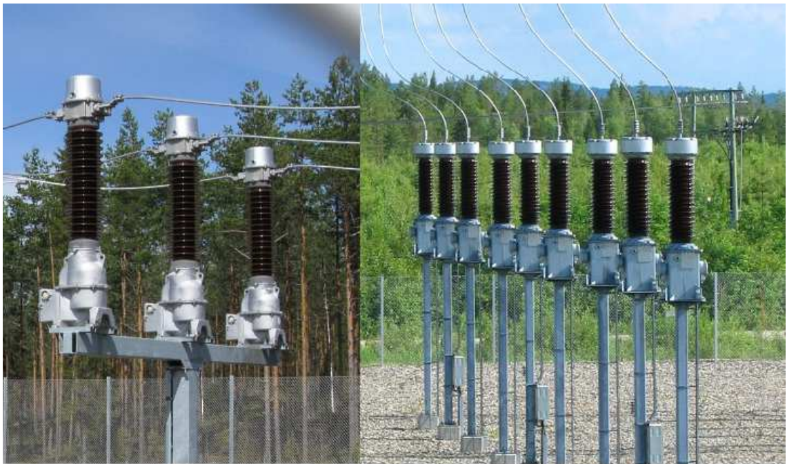
KUVA 9. Mittamuuntajat. Oikealla virtamuuntaja (Kuvannut: Janne Määttä) ja vasemmalla jännitemuuntaja (Kuvannut: Jouko Järvinen).
