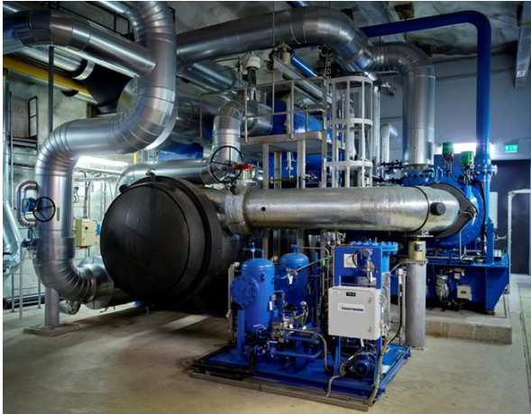
Kuva 3. Yksi Katri Valan viidestä 12 MW:n lämpöpumpusta (Katri Valan lämpöpumppulaitos).
