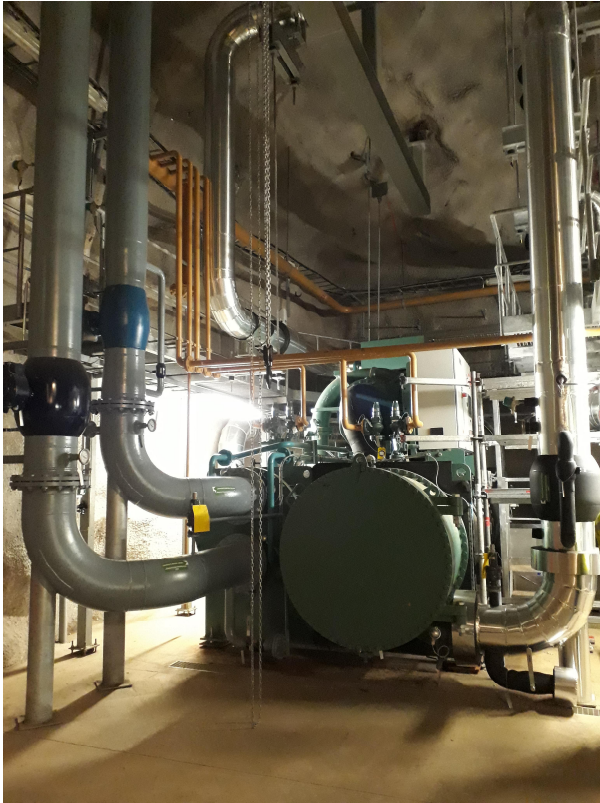
Kuva 2. Toinen Salmisaaren uusista 5 MW:n kompressoreista.
