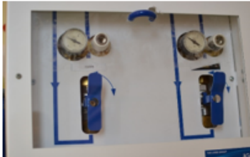
Hapen ja ilman sulkuventtiilit osaston kanslian seinässä. Kuvassa venttiilit auki-asennossa. Venttiili suljetaan kääntämällä se vaakatasoon nuolen osoittamalla tavalla.
