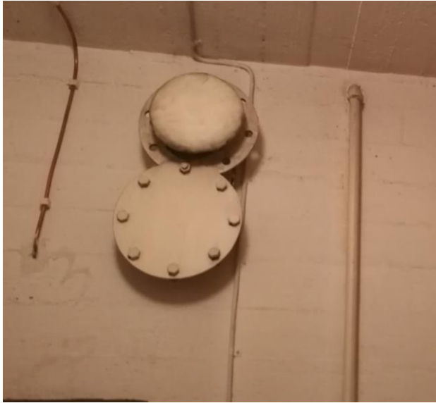
Kuva 9. Normaaliolojen ilmanvaihdon sulkulaite IS-1 kiinnitettynä läpivientiputkeen LP-1 (kuva Tero Huttunen)
