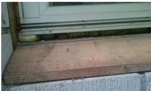
Lämpökuvauskohta 2. (karmittiivistys vajaa)
