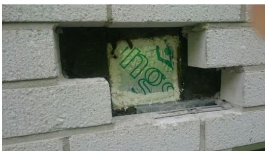
Lämpökuvauskohta 5. (ikkunan yläpuoli)
