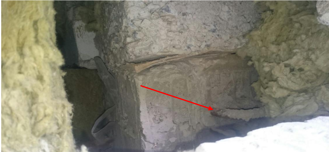
Kuva 9. Teräsosa betoniseinässä ja höyrinsulkumuovi rutussa seinän sisällä.
