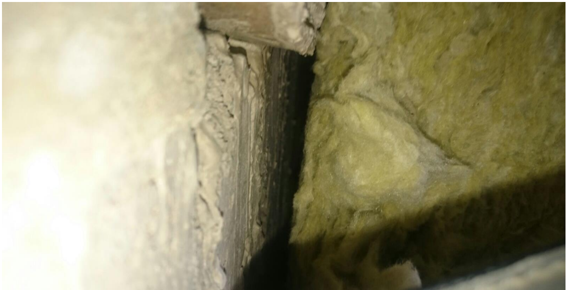
Kuva 8. Mineraalivilla on epätiivisti betonirunkoa vasten, koska holvivalu ylittää seinälinjan.
