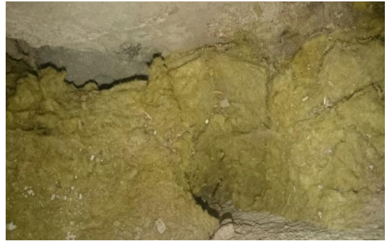
Lämpökuvauskohta 3. (eristetilassa reikiä)
