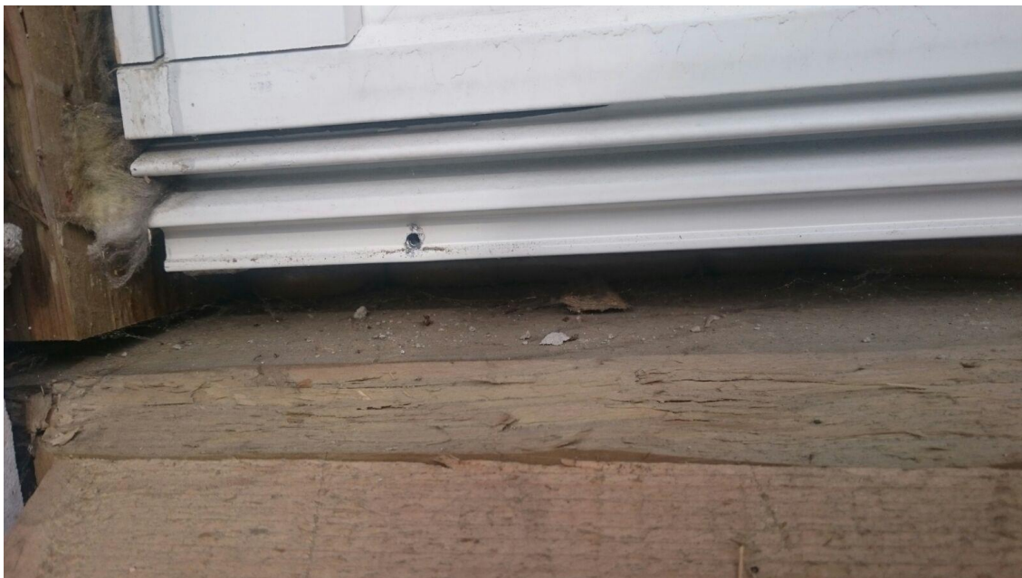
Kuva 10. Puutteellinen ikkunan karmieristys.
