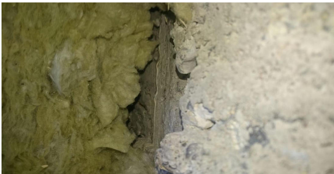
Lämpökuvauskohta 1. holvivalu tulee seinälinjasta yli, jonka vuoksi eristeet eivät ole tiiviisti betonia seinää vasten.
