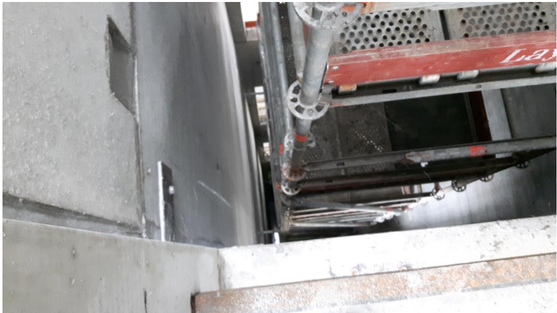
Kuva 1. Hissikuiluun asennettu teline. Vasemmalla nähtävissä elementtiseinään tehtyä saumaustyötä. Kuilun pohja ei aivan näy.
