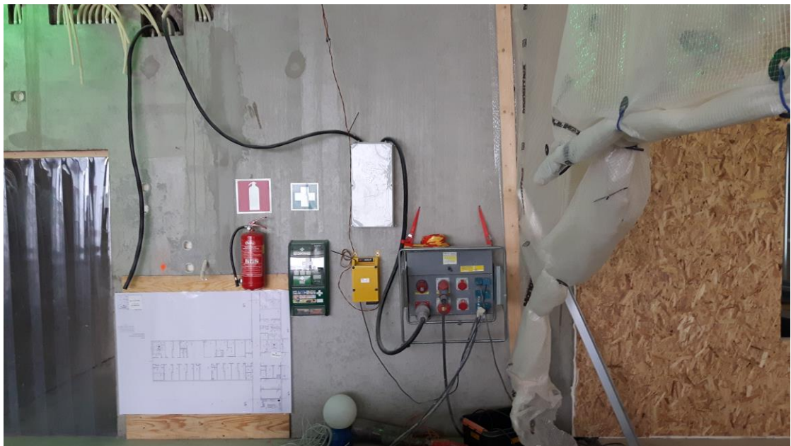
Kuva 2. Työmaansähköistys. Vasemmassa yläreunassa nähtävissä keskuksen syöttökaapeli, joka kulkee elementtiseinän sisällä sille varatulla reitillä.
