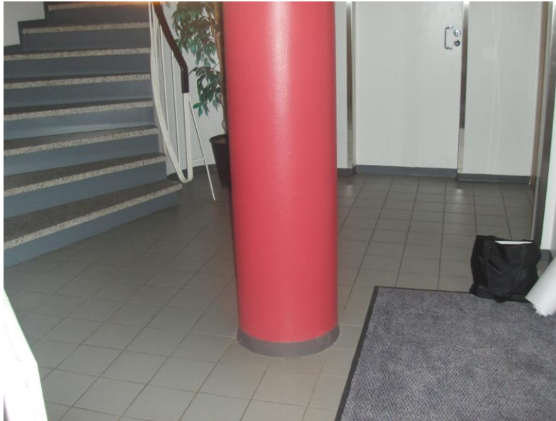
Kuva 2. Punainen pylväs keskellä porraskäytävää.
