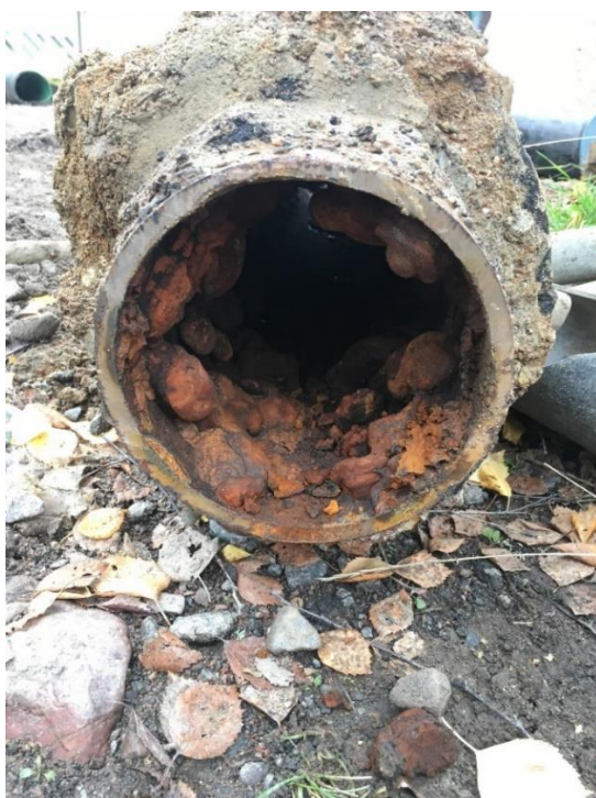
KUVA 1. Valurautaisen vesijohdon kiinteitä saostumia (Vauhkonen 2017-08-15)
