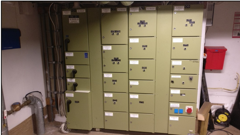
Kuva 17. Ryhmäkeskus, joka jakaa sähköä tilassa toimiville toimilaitteille
