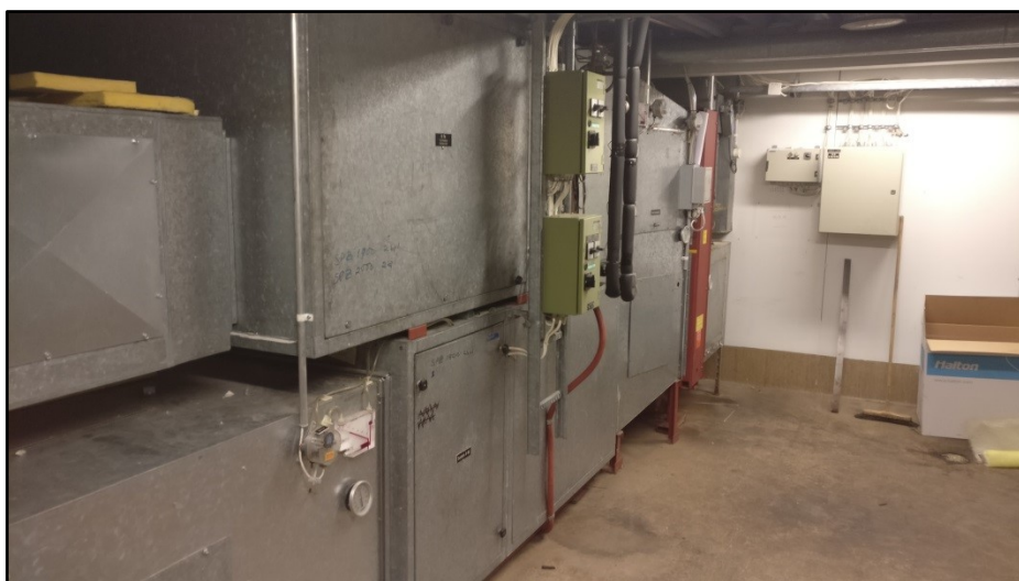
Kuva 18. Kuvassa näkyy seinällä vanha säätölaittekeskus, joka säätelee LVI-järjestelmää
