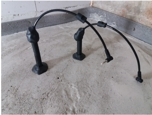
KUVA 5. Mittapääät asennettuina asennusputkiin. Mittapään johdon ja putken väli tiivistetty huolellisesti vesihöyryntiiviillä kitillä.
