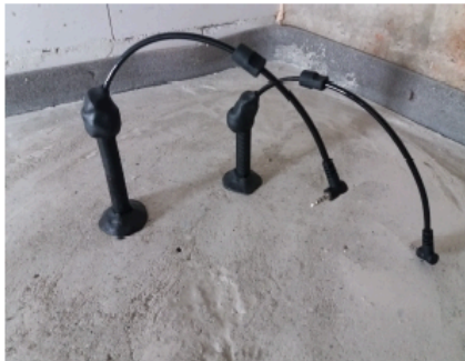
Mittapääät asennettuina asennusputkiin. Mittapään johdon ja putken väli tiivistetty huolellisesti vesihöyryntiivillä kitillä (kohta 13)
