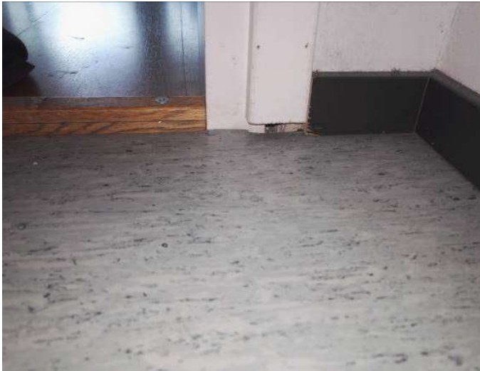
KUVA 28. Karmin ja lattian liittyminen epätiivis
