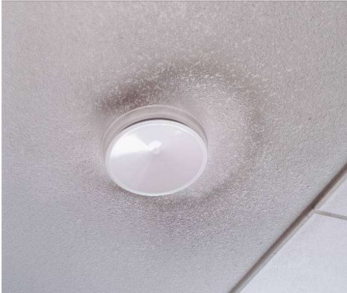
KUVA 52. Venttiilien ympäristät ovat likaiset
