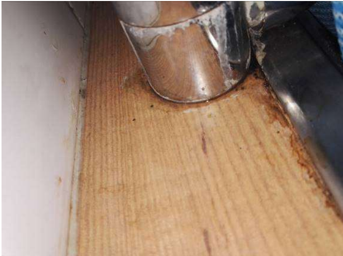
KUVA 21. Kosteusjälkiä hanan vierellä
