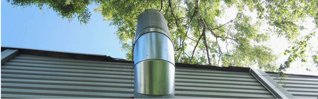
KUVA 14. Räystäsrakenteessa kulumaa, reunapellistä puuttuu osa
