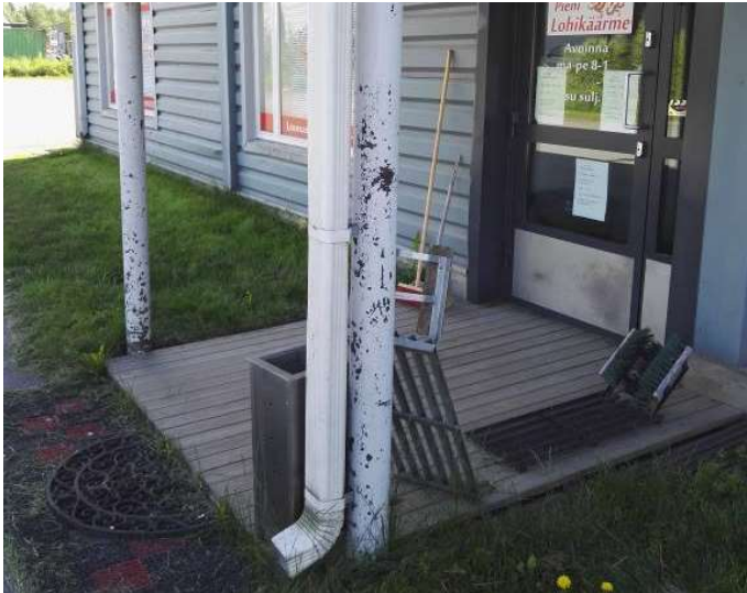
KUVA 15. Pilareiden maali on rapistunut
