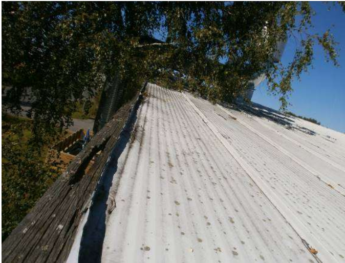
KUVA 19. Osa reunapelistä puuttuu
