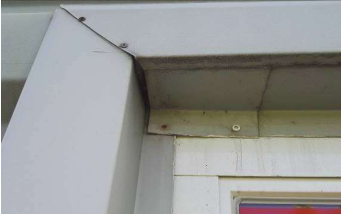
KUVA 16. Ikkunoiden peltien liittymät rakoavat
