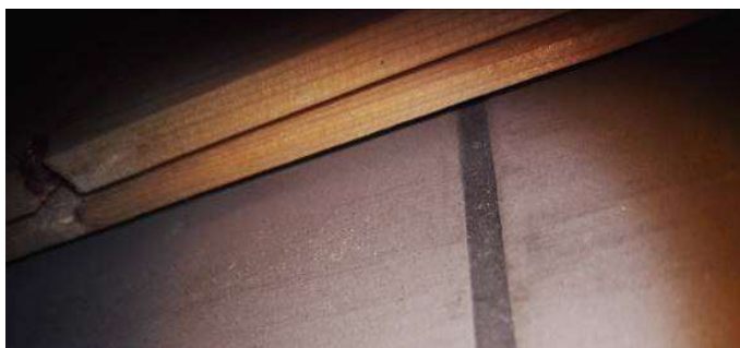
KUVA 33. Tuuletusrako on ummessa
