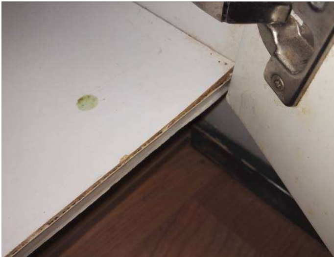
KUVA 20. Kosteus turpoamaa levyssä
