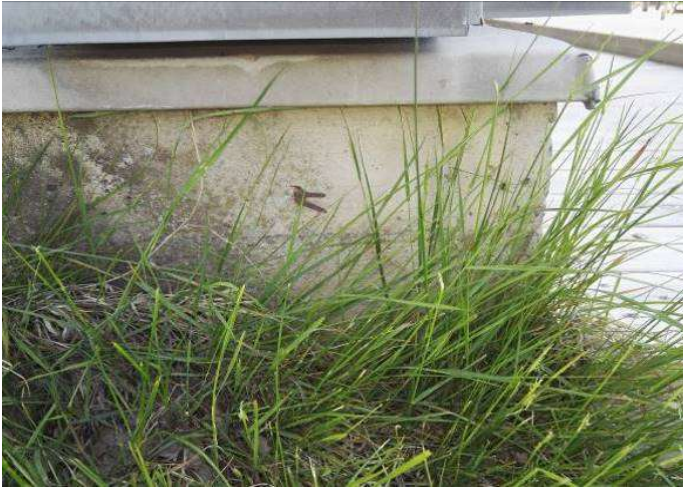
KUVA 10. Sokkelissa ruostunutta rautaa
