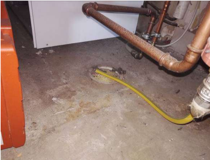
KUVA 49. Varoventtiin poistoputki on johdettu viemäröintiin
