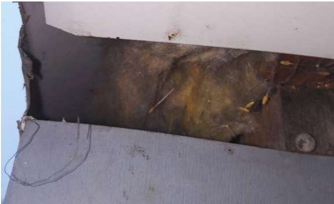
KUVA 17. Ulko-oven liittymien pellitykset rakoavat, villaa ja puuta näkyvissä
