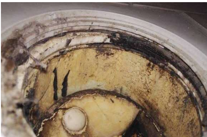
KUVA 31. Kaivon liittymät epätiivit
