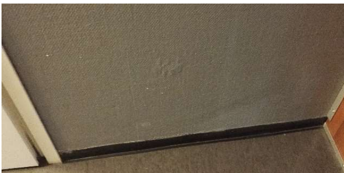
KUVA 40. Seinässä havaittu kohoumaa
