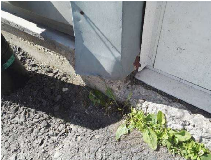
KUVA 4. Asfaltin ja sokkelin väliä ei ole tiivistetty
