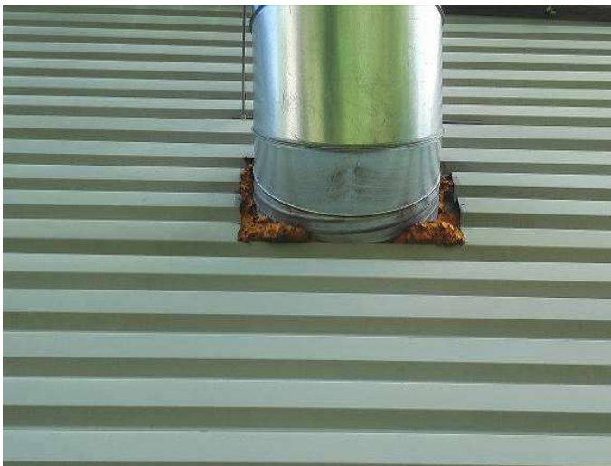
KUVA 13. Julkisivujen läpiviennit ovat epätiivitä
