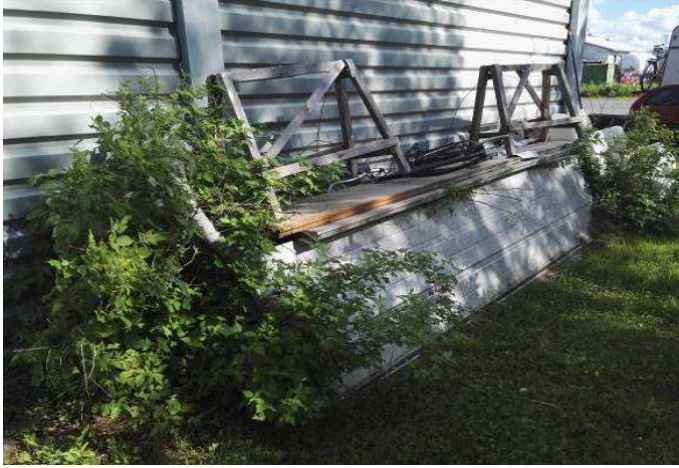
KUVA 8. Seinän vieressä tavaraa ja kasvillisuutta
