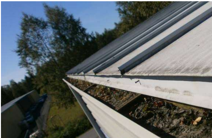
KUVA 18. Vesikaton reunapellissä ylösnousseita nauloja
