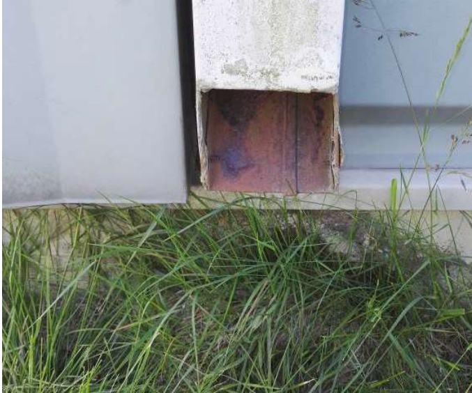
KUVA 6. Sadevesien poisjohtaminen on puutteellista
