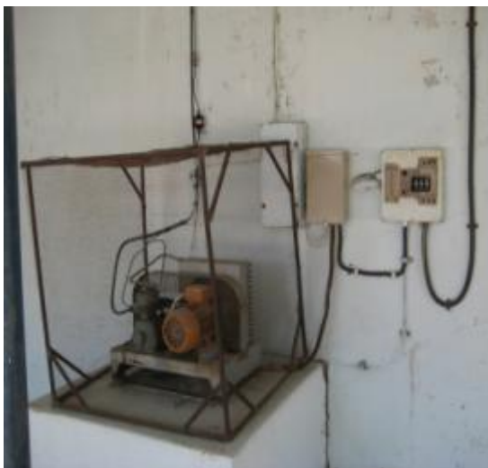
Kuvio 4. Apteekin kylmähuoneen kompressorin asennukset.
