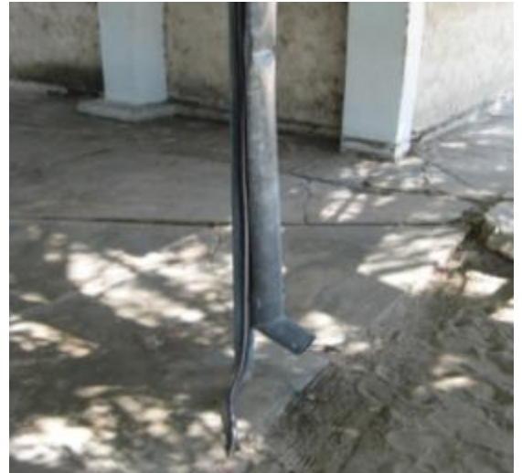
Kuvio 5. Erään rakennuksen suojaamaton syöttökaapeli.
