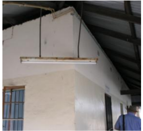
Kuvio 9. Katoksien valaisimet ovat korroosion turmelemia ja huonokuntoisia sekä ilman heijastimia ja suojuksia.
