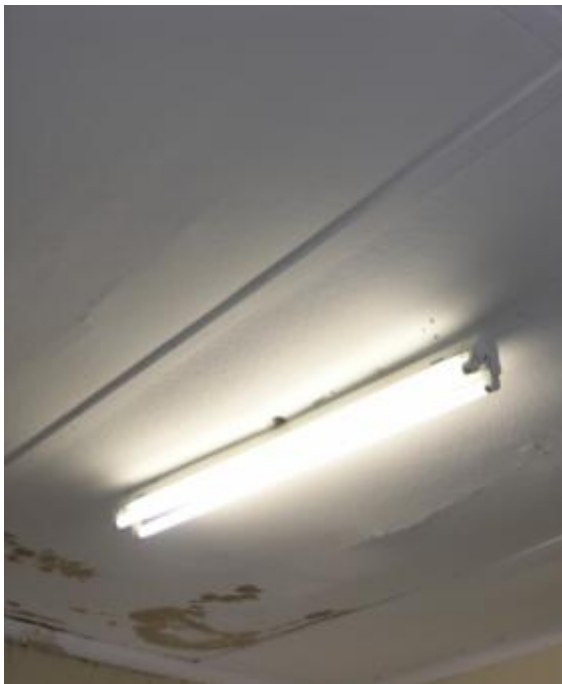
Kuvio.8. Sisävalaistus on toteutettu avonaisilla valaisimilla ja niiden kiinnitykset ovat heikolla tasolla.
