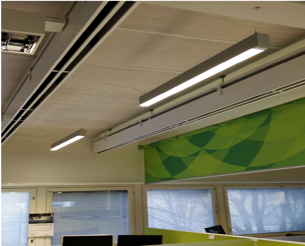
Kuva 38. Ensimmäisen kerroksen Philips Trueline -valaisimet asennettuna.
