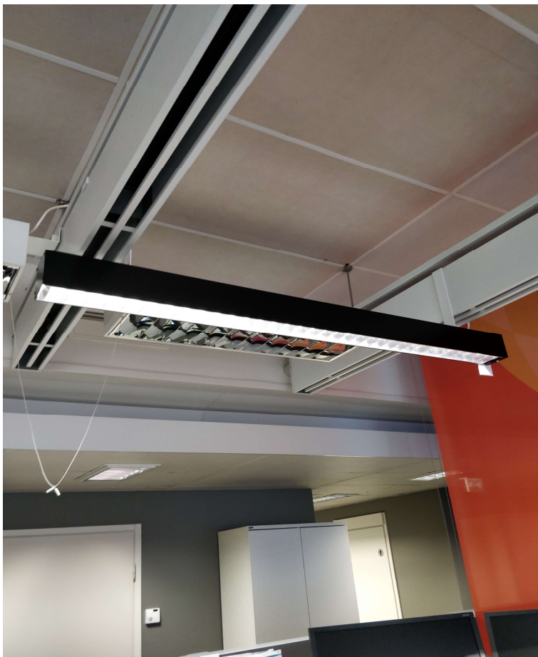
Kuva 24. Elektro-Valon AL-valaisin asennettuna.
