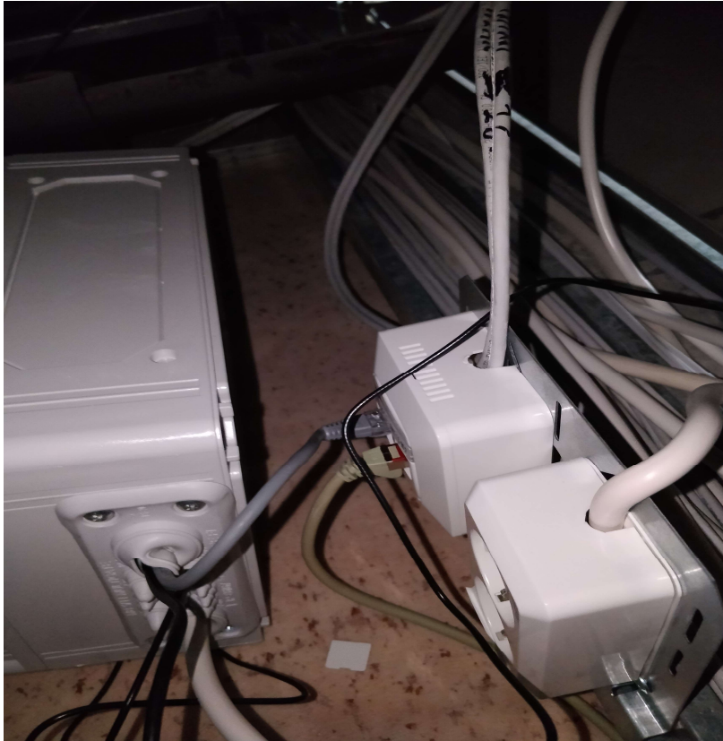
Kuva 56. keskusyksikkö asennuskotelossa alas lasketun katon yläpuolella.
