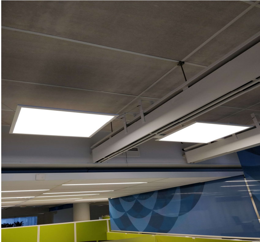
Kuva 55. Elektro-Valon Ledpanel Narrowframe -valaisimet asennettuna.
