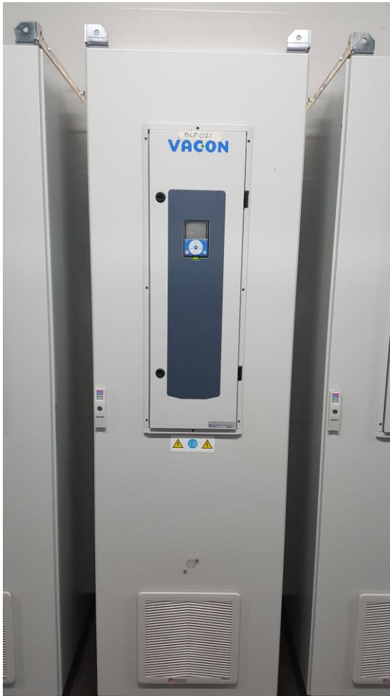
KUVA 17. Radiaattoreita ohjaava taajuusmuuttaja
