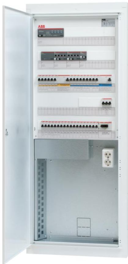
Kuva 2. Integroitu kotijakamo sijaitsee keskuksen alaosassa.
