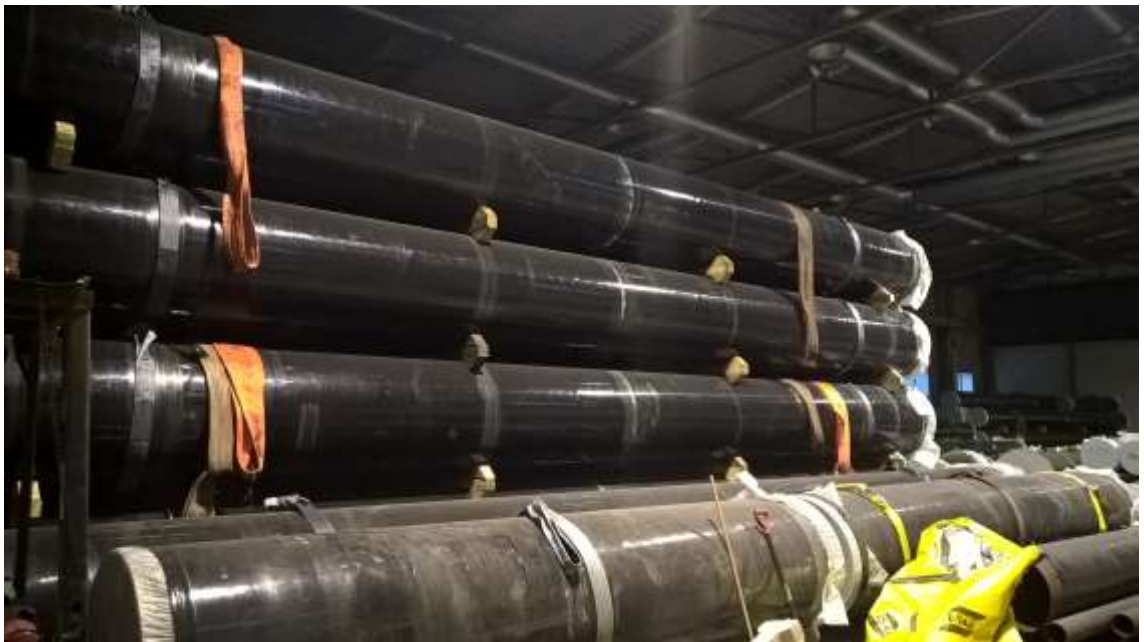
KUVA 19. Pinnoitetuista putkista tehty putkinippu
